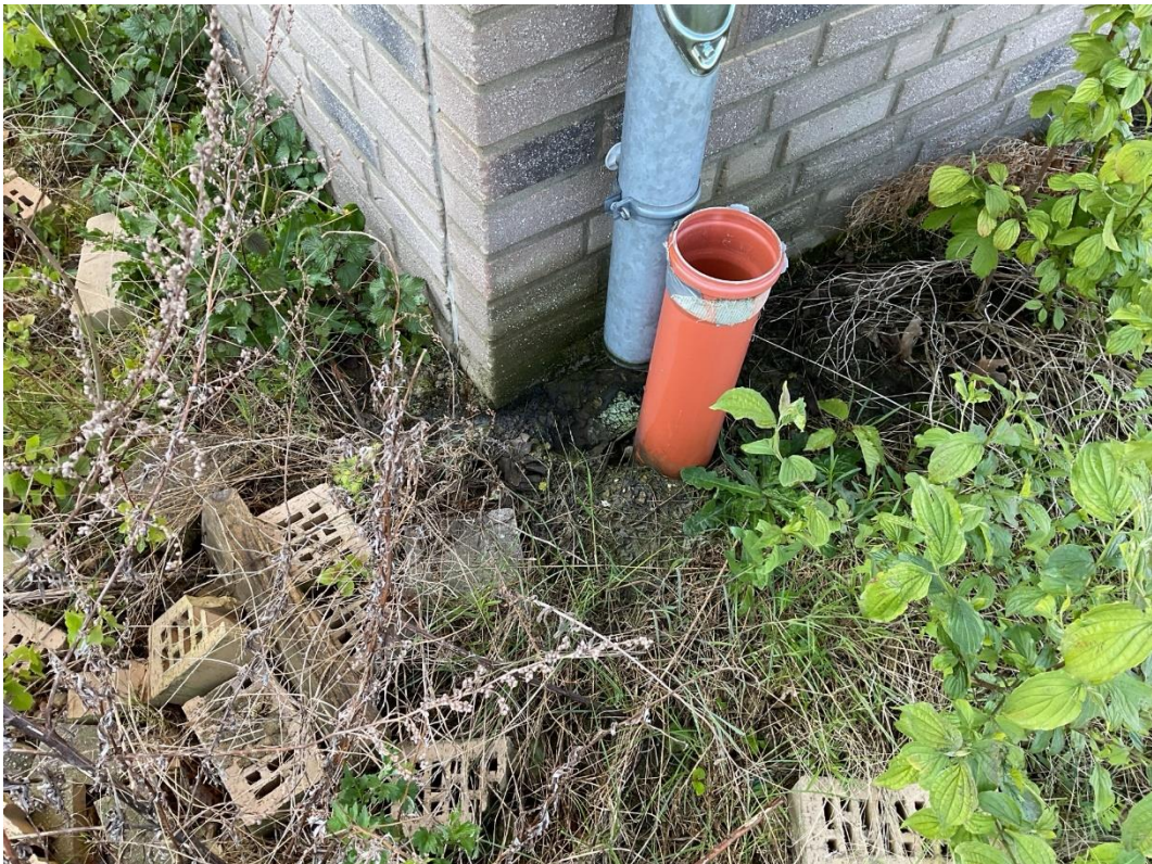
Bild 5: fehlender Anschluss Dachentwässerung, hier: Straßenseite
