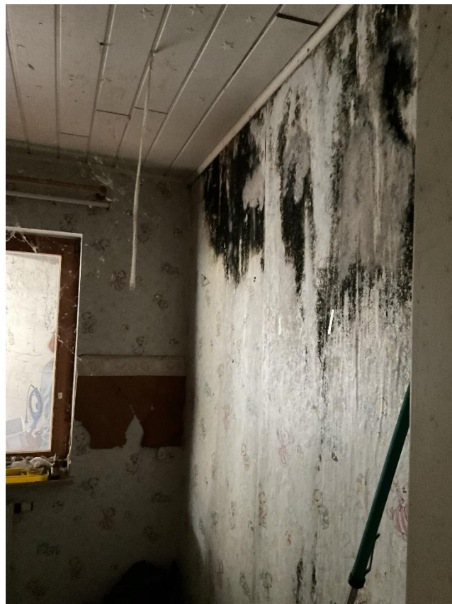
Bild 11: Schadenbild Kinderzimmer Nebengebäude
