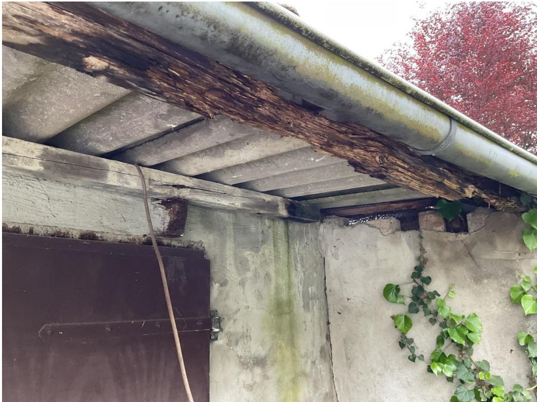
Bild 12: durchfeuchteter Tragbalken an Überdachung Nebengebäude
