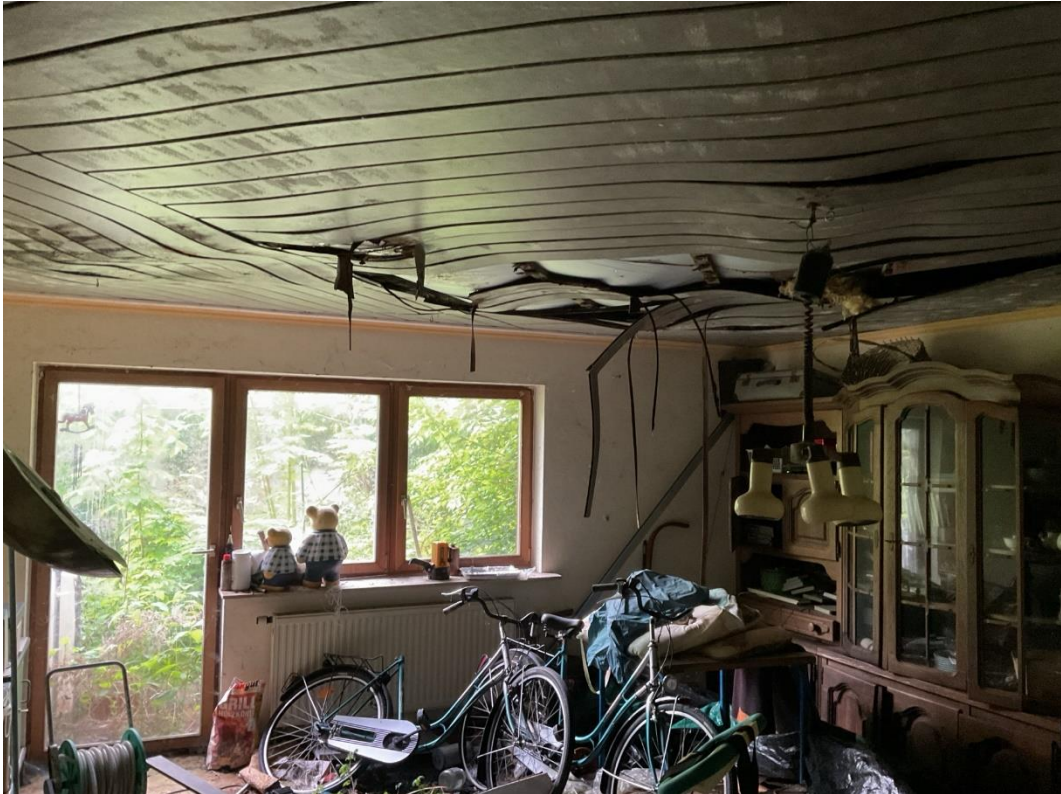
Bild 10: Schadenbild Wohnzimmer Nebengebäude
