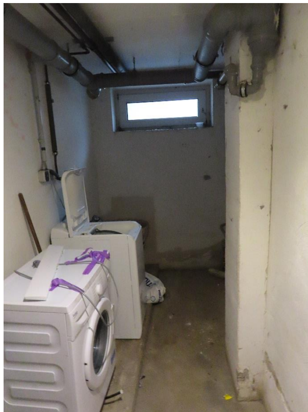
Abb. 8: Waschen im Kellergeschoss
