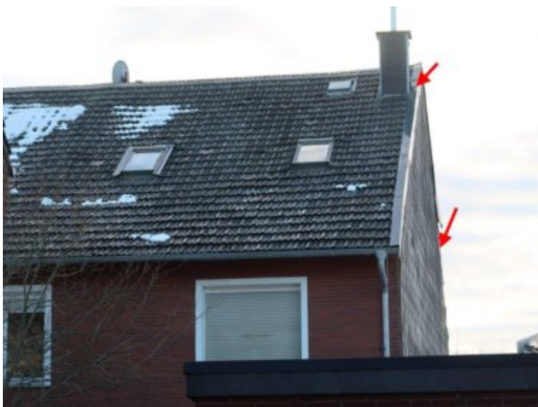
Bild 6 Zustand Fassade und Organg
