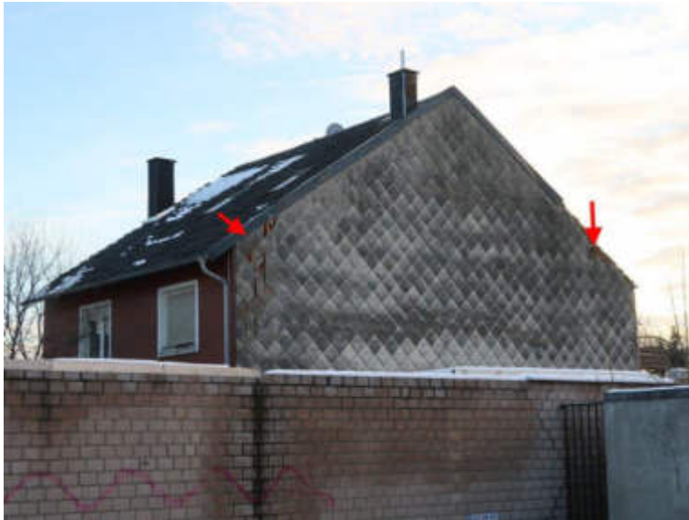
Bild 7 Zustand Fassade seitlich
