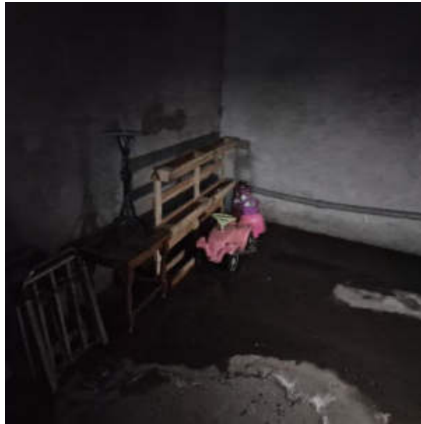
austretendes Wasser im Keller "Holzstraße 22"
