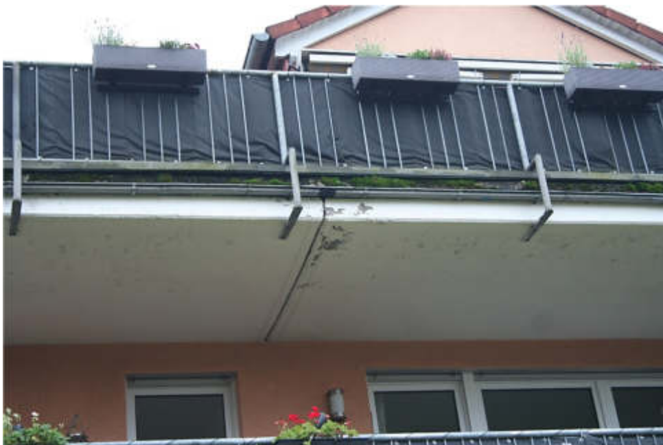
Bild 8: Feuchtigkeitsschäden an den Balkonen erkennbar
