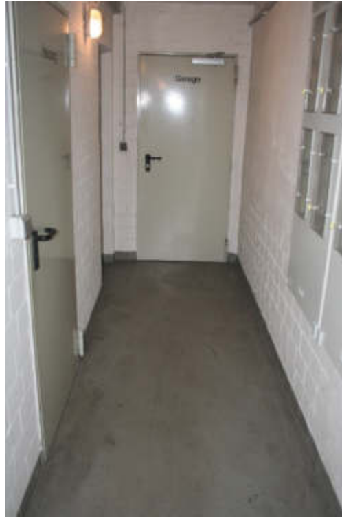
Bild 17: Kellerflur / Elektrounterverteilung aufgehängt
