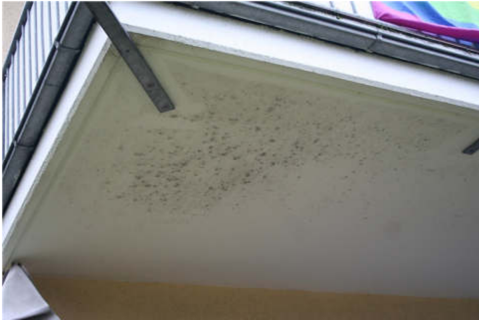
Bild 11: Feuchtigkeitsschäden an den Balkonen erkennbar
