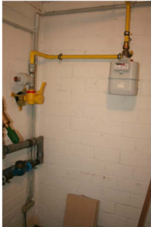
Bild 21: Hausanschlussraum / Versorgungsanschlüsse / Gasuhr
