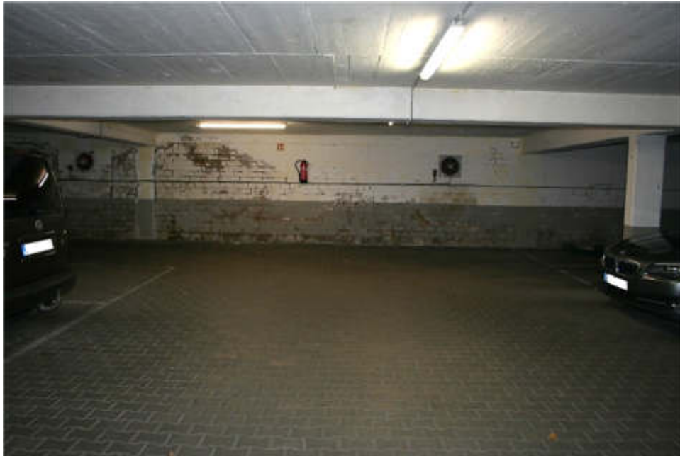
Bild 15: Feuchtigkeitseinwirkungen in der Tiefgarage erkennbar
