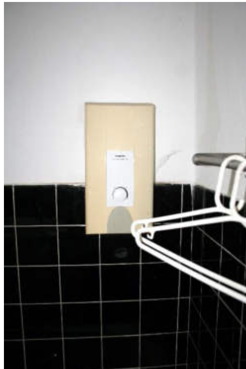
Bild 38: elektr. Durchlauferhitzer im Bad
