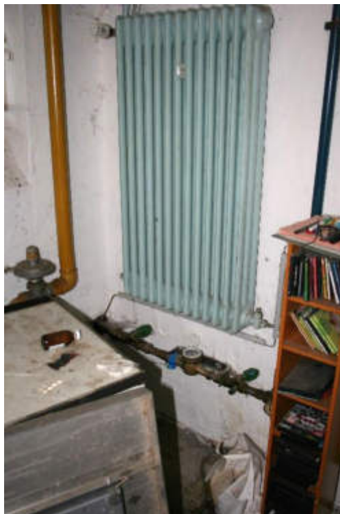
Bild 20: Hausanschlussraum – beheizt / Wasseranschluss
