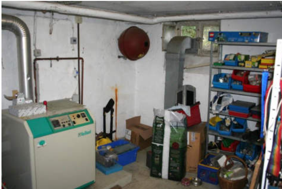
Bild 24: Heizungsanlage im KG
