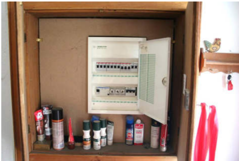
Bild 28: Elektrounterverteilung im Treppenhaus
