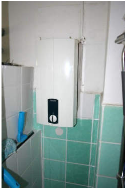
Bild 52: elektr. Durchlauferhitzer im Bad
