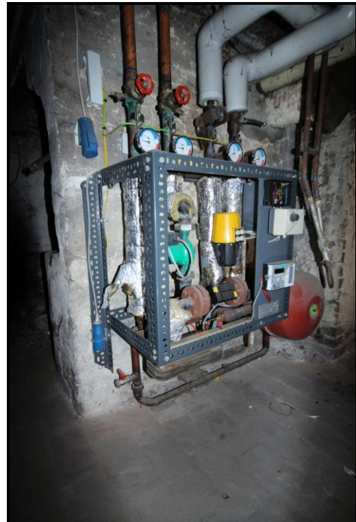
Bild 22: Fernwärmeanschluss des Teileigentums Nr. 4
