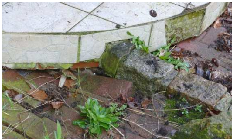
A9 Zustand der Eingangsstufe
