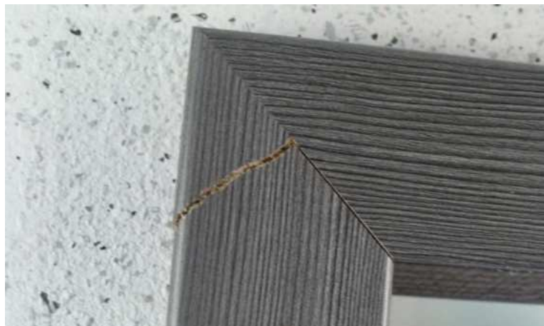
B9 Flur im DG: Türzarge beschädigt
