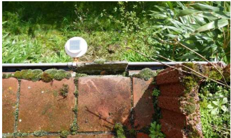
A5 Zustand des Balkons | Fliesenbelag abgängig
