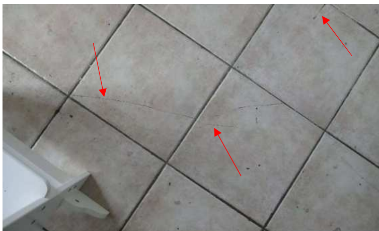
B2 Küche: Risse im Fliesenbelag
