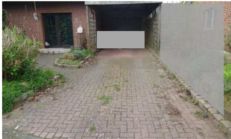
D7 Zustand der Einfahrt zur Garage
