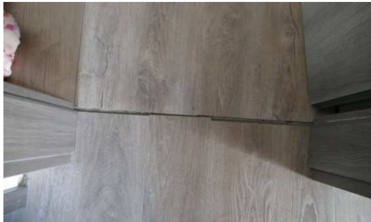
B8 Bodenbelag im DG: Übergangsschienen fehlen
