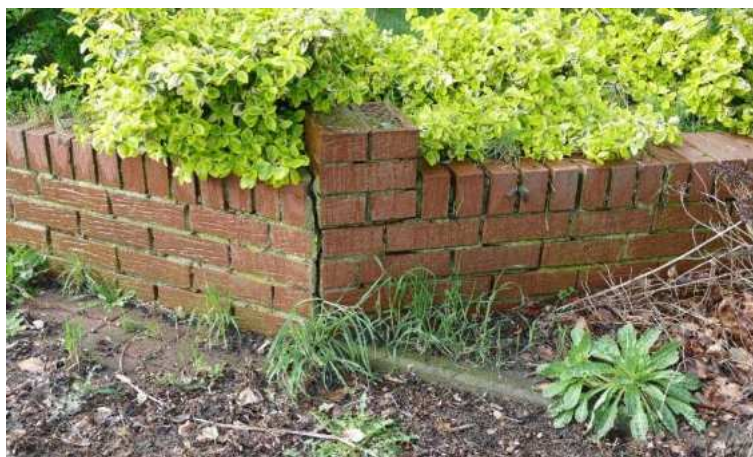
D4 Zustand der Einfriedung
