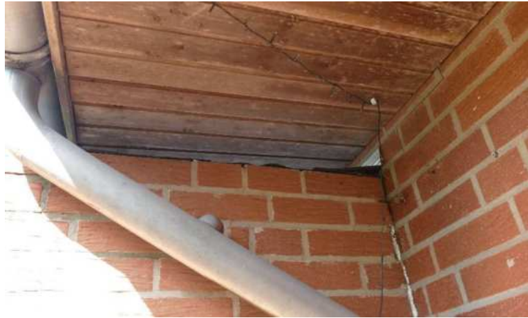
A7 Gebäudetrennfuge zwischen Garage & Wohnhaus nicht verfüllt
