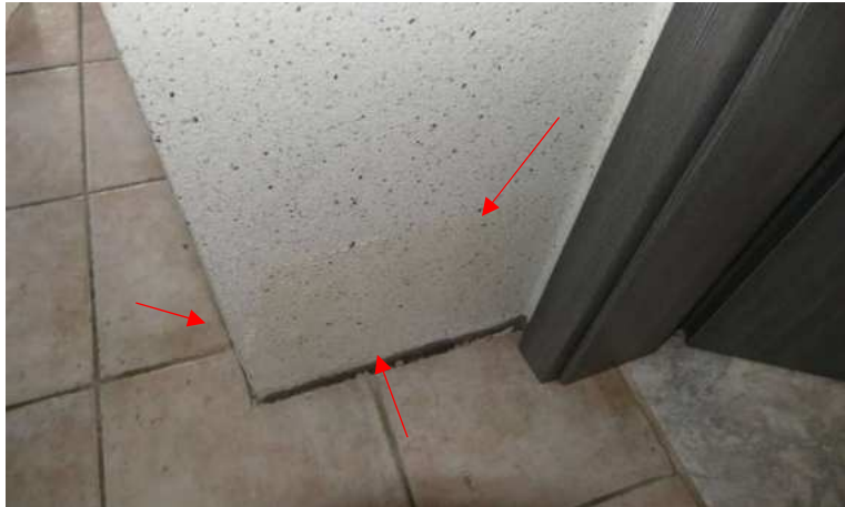
B4 Diele: Feuchtigkeit im unteren Wandabschnitt des Mauerwerks am Kaminzug, umlaufend, Messwerte = 100 Digit (100 = max. Wert)
