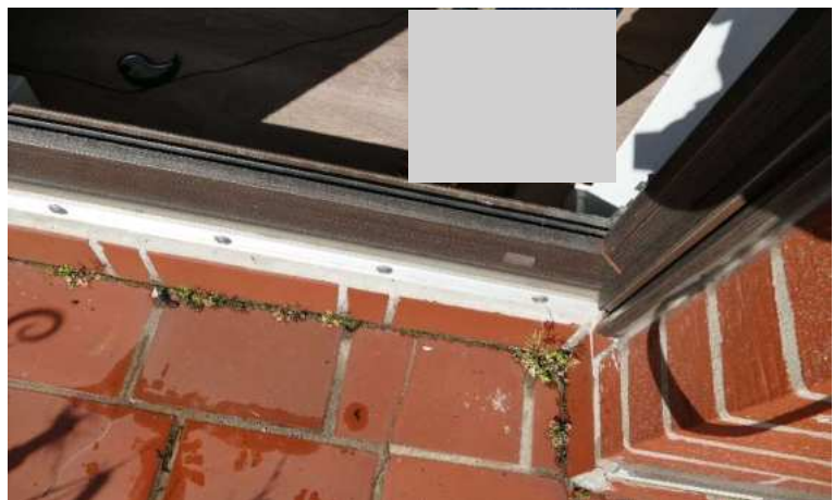
A6 Zustand des Balkons | Rissbildung im Fliesenbelag (Moosbewuchs)
