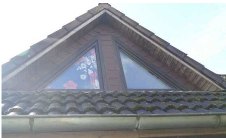
A3 Zustand der Dachüberstände an der Gaube
