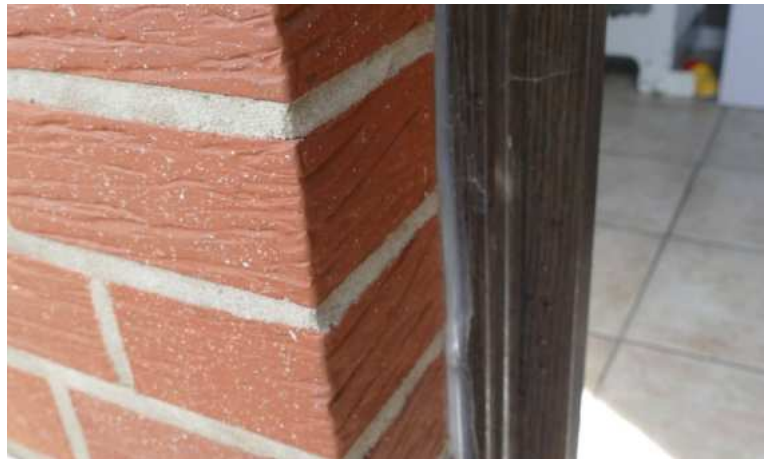
A8 Fugen zwischen Blendrahmen und Fensterleibung nicht fachgerecht ausgeführt
