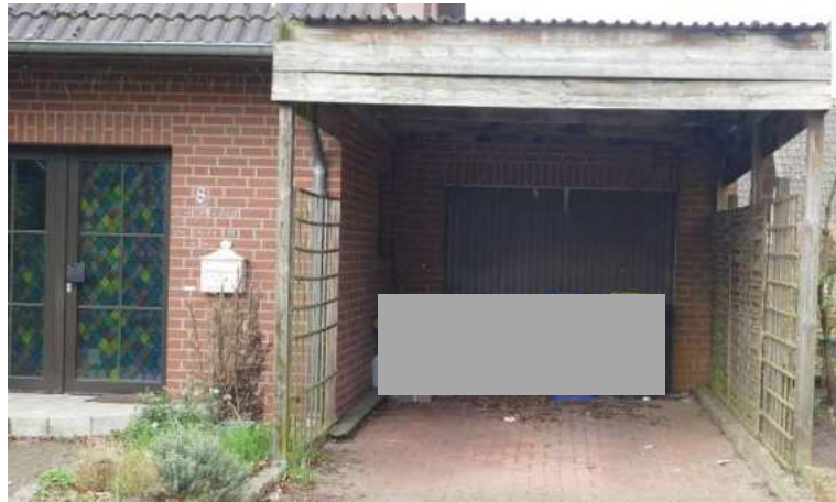
D6 Zustand der Überdachung, siehe Abschnitt 1.2 „Hinweise“
