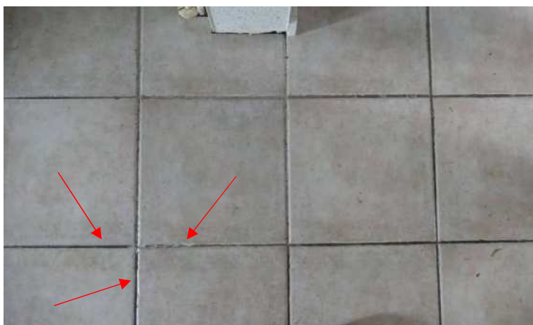
B3 Diele: Fugenmaterial fehlt tlw.
