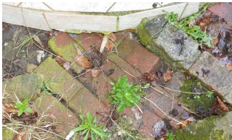
D2 Zustand der Pflasterung im Bereich des Hauseingangs
