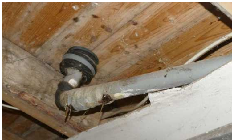
C2 Deckenverkleidung in Teilen demontiert | Undichtigkeit in der Dachentwässerung
