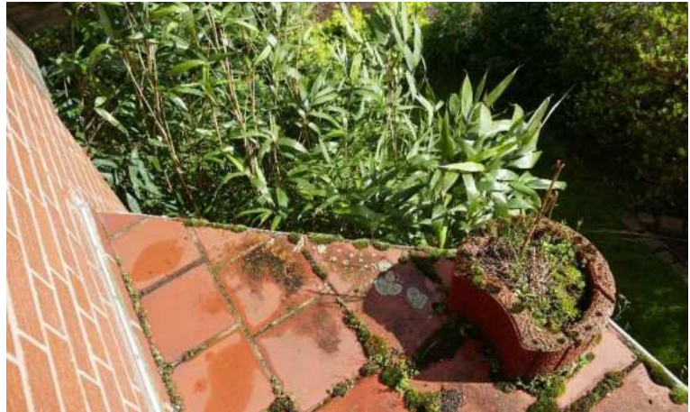
A4 Zustand des Balkons | Absturzsicherung fehlt
