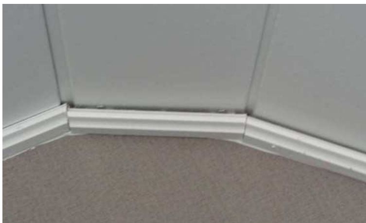
B11 Schlafrum: Zustand der Randleisten an der Deckenverkleidung
