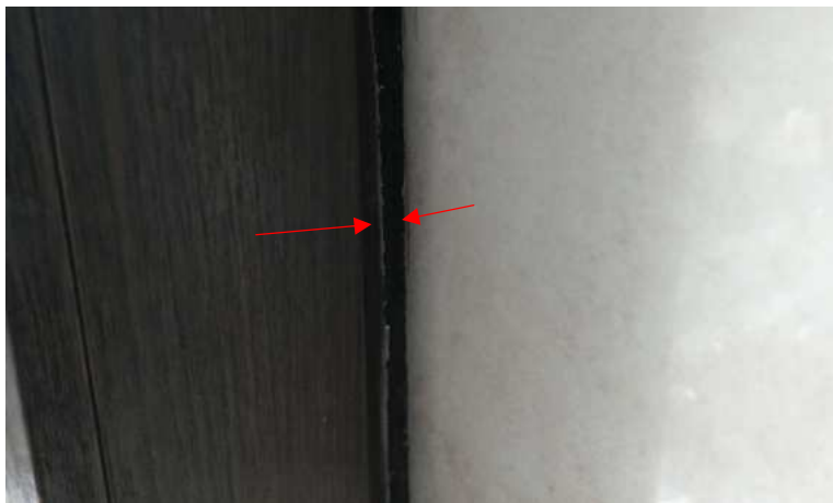
B6 Fuge zwischen Leibung und Blendrahmen tlw. offen (Zugluft)
