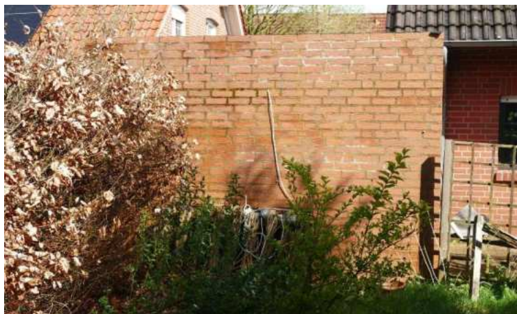
C1 umlaufende Attika fehlt | Feuchtigkeit im Verblendmauerwerk
