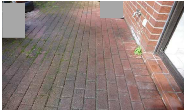
D1 Zustand der Terrasse | Gefälle zum Wohnhaus
