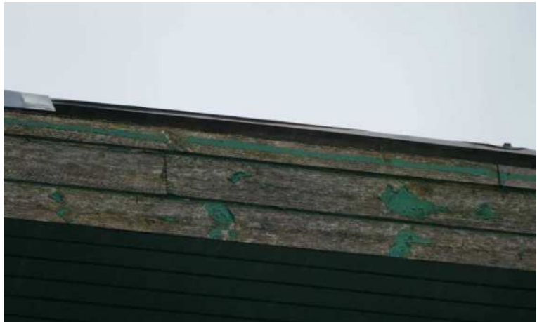
A2 Erhaltungsanstrich der Holzverkleidungen fehlt
