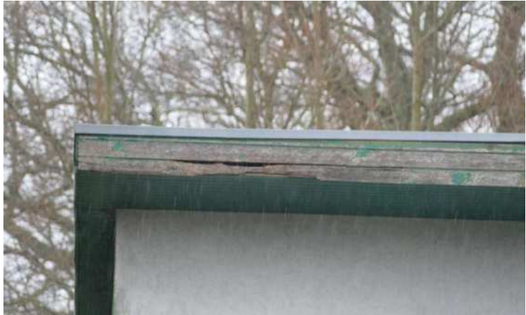
A1 Holzverkleidungen des Dachüberstandes vermutlich durch Witterungseinflüsse beschädigt (Austausch); Erhaltungsanstrich nicht ausgeführt
