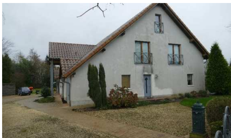
B3 Giebelfassade (westlich) vermutlich durch Witterungseinflüsse verunreinigt
