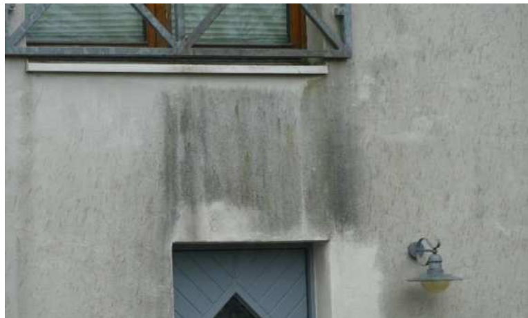
B4 Zustand der Fassade oberhalb der Außentür (Nebeneingang)
