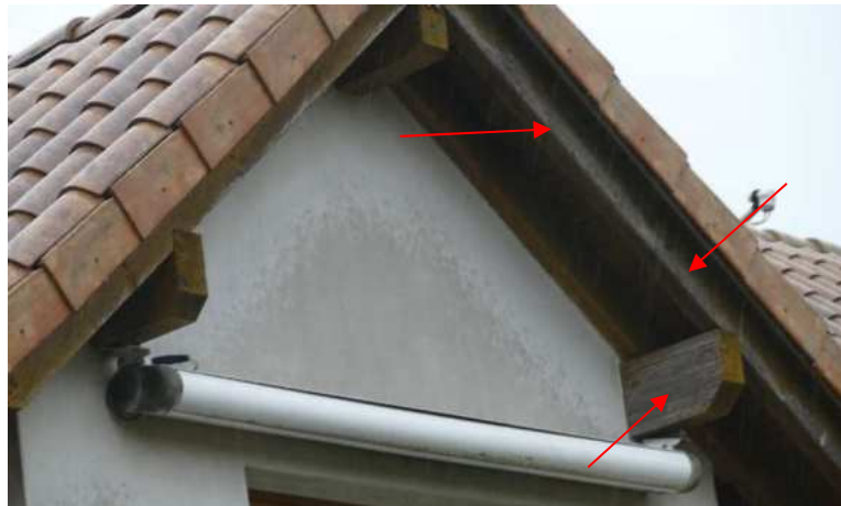
B1 Anstrich der Holzbauelemente am Dachüberstand vermutlich durch Witterungseinflüsse beschädigt
