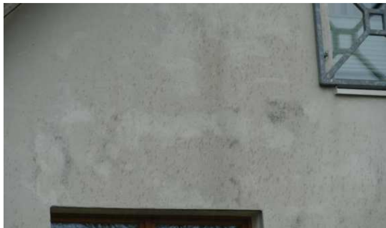
B5 Zustand der Fassade oberhalb des Fensters „Zimmer 2“
