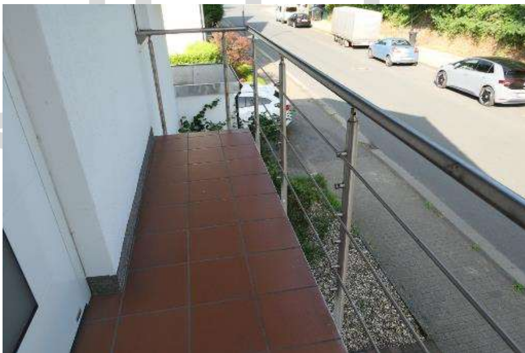
Bild 10 Sicherungstreben des Geländers fehlen
