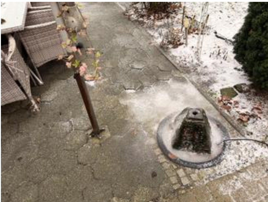
Unebenes Plaster der Terrasse
