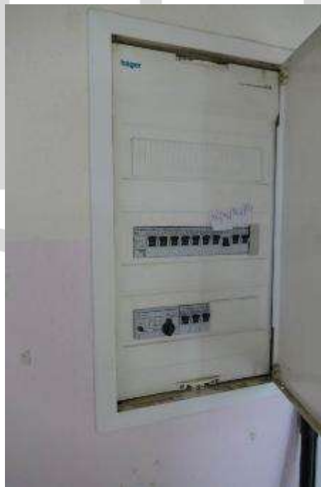
Bild 18 Elektrounterverteilung der Wohnung
