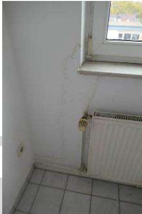
Bild 21 Feuchtigkeitsschaden am Fenster
