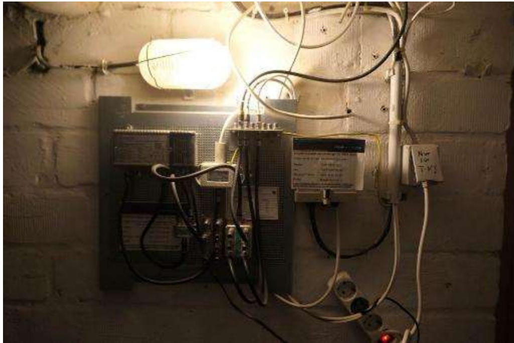
Bild 29 Kabelzugang im Kellergeschoss
