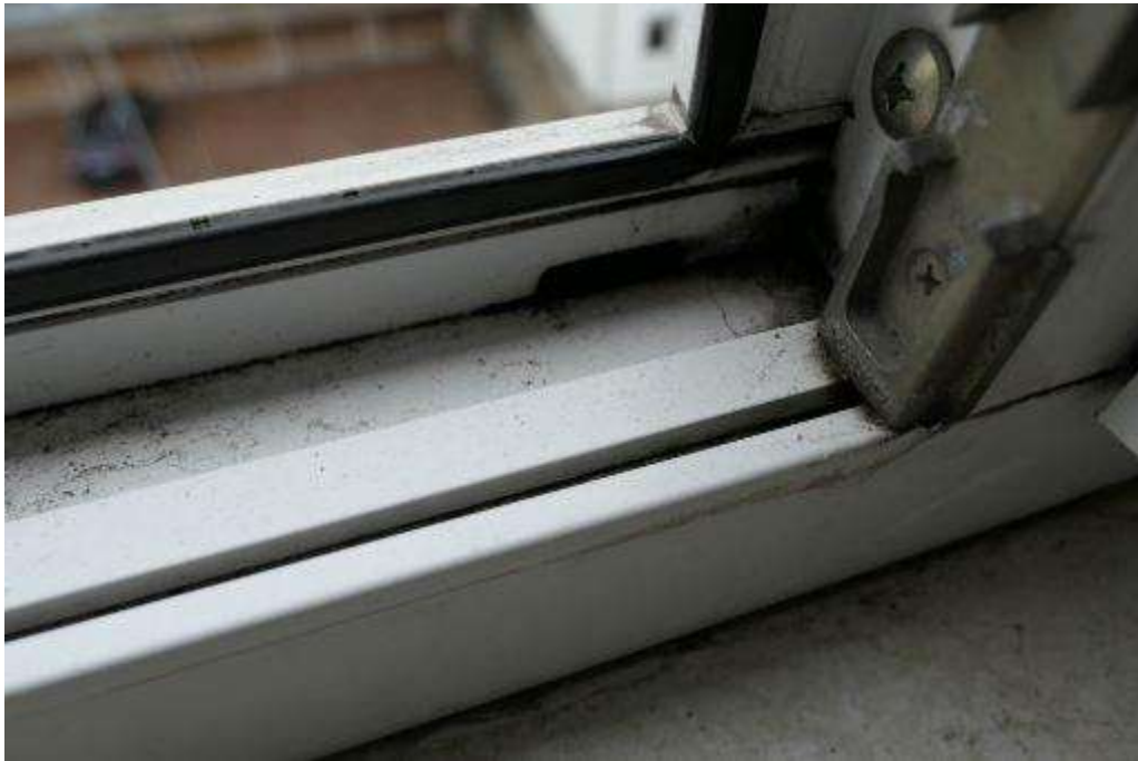
Bild 23 verstopfte Wasserabläufe im Fensterrahmen
