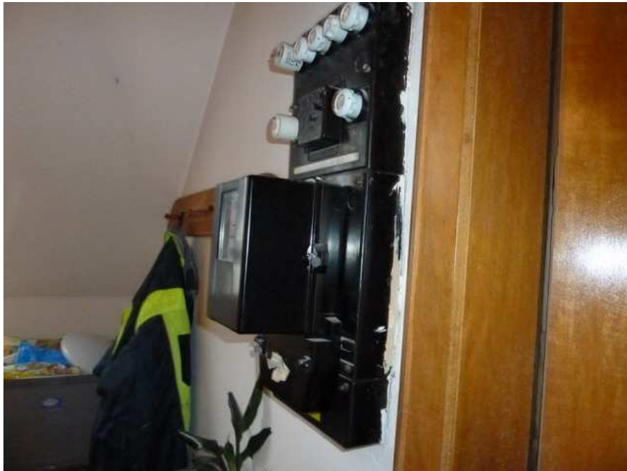
Stromverteiler im Dachgeschoss
