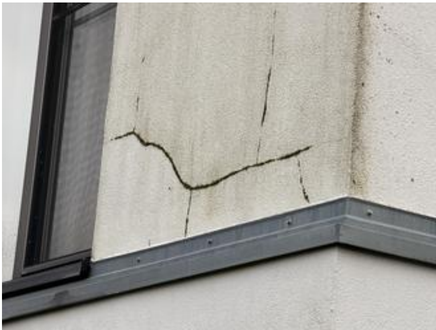
Risse im Außenputz des 1.OG's und darüber, Süden
