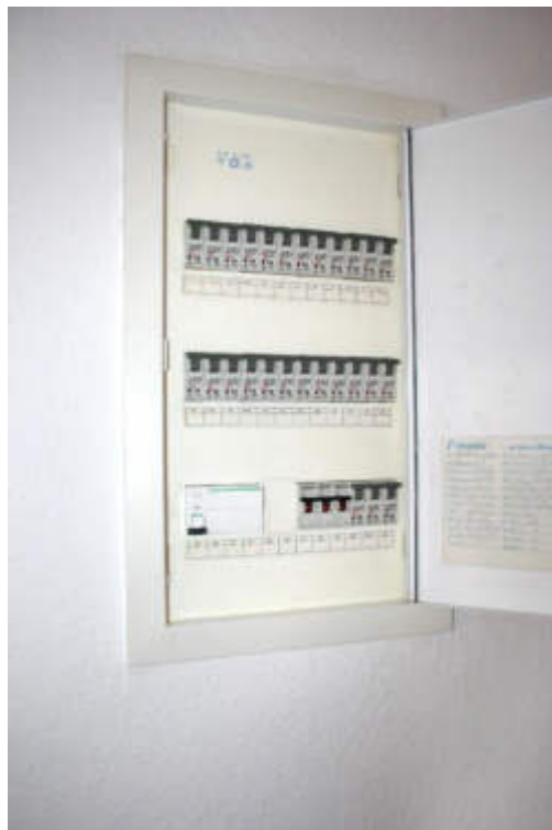
Bild 18: Elektrounterverteilung der Wohnung
