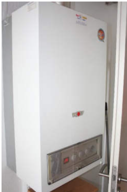
Bild 38: Gasetagenheizung der Wohnung
