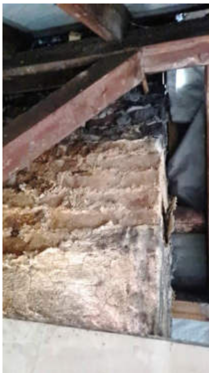
Bild 46: versotteter Kamin im Dachboden
