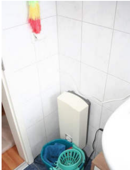
Bild 35: elektr. Durchlauferhitzer im Bad
