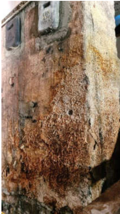
Bild 45: versotteter Kamin im Dachboden
