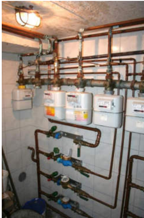
Bild 13: Versorgungsanschlüsse im Keller / Gasuhren
