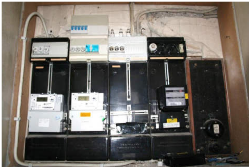
Bild 16: Elektrounterverteilung im Treppenhaus
