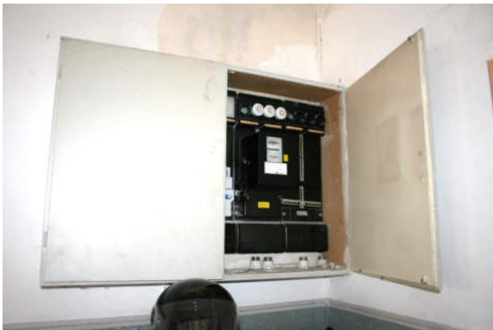
Bild 32: Elektrounterverteilung im Treppenhaus
