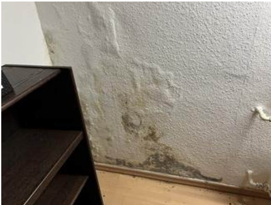
Feuchte in Kellerwand
