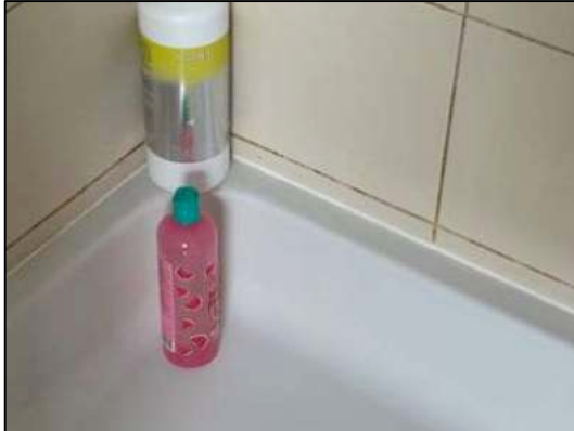
Dusche: Schimmelbildung in den Fugen
