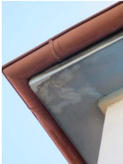
Feuchtigkeitsschaden an Dachüber-
