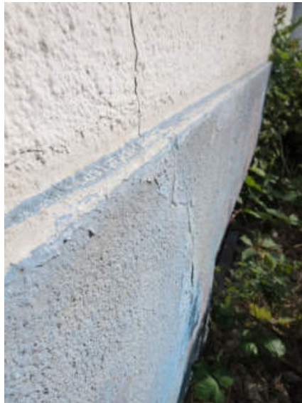
Schäden an der Fassade
