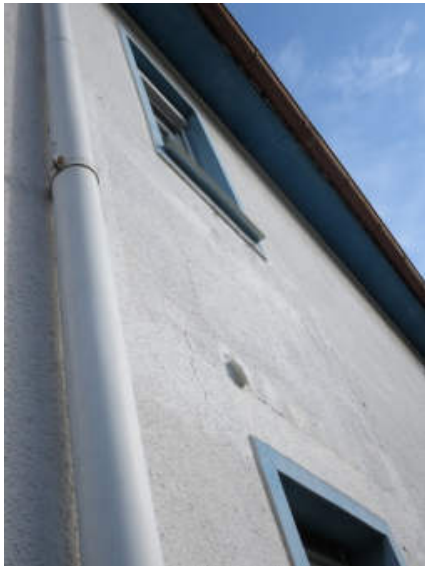
Schäden an der Fassade
