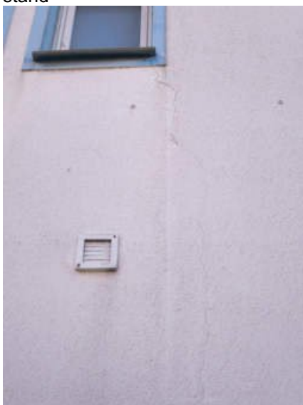
Schäden an der Fassade
