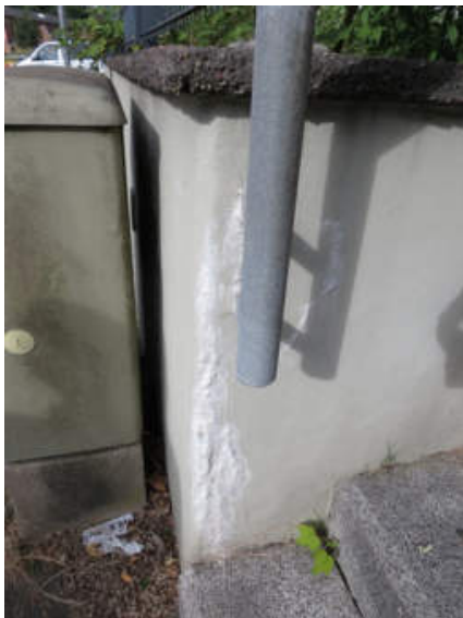
Schäden an Einfriedungsmauer
