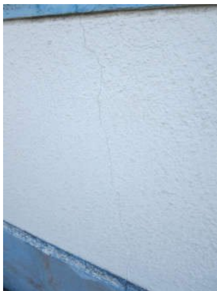
Schäden an der Fassade
