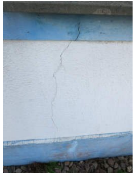
Schäden an der Fassade
