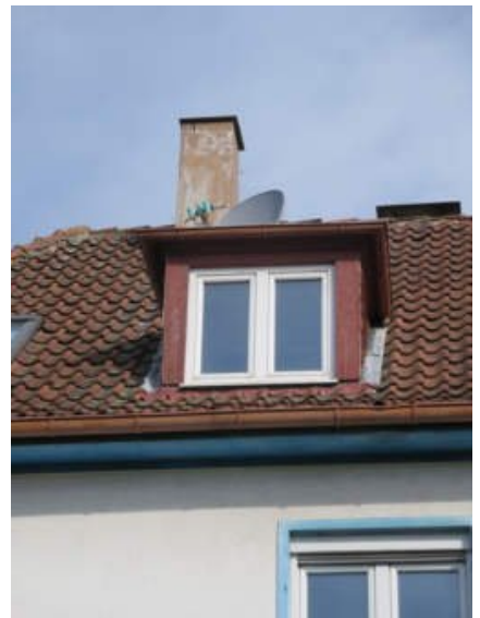
optische Mängel an Dachgaube
