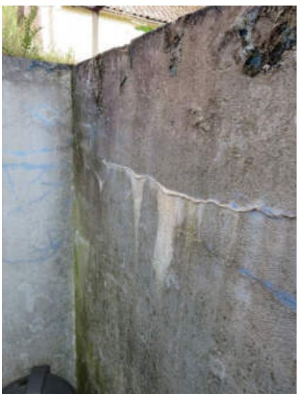
Schäden an Kelleraußenzugang
