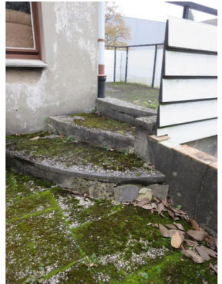
Schäden an Terrasse (EG)
