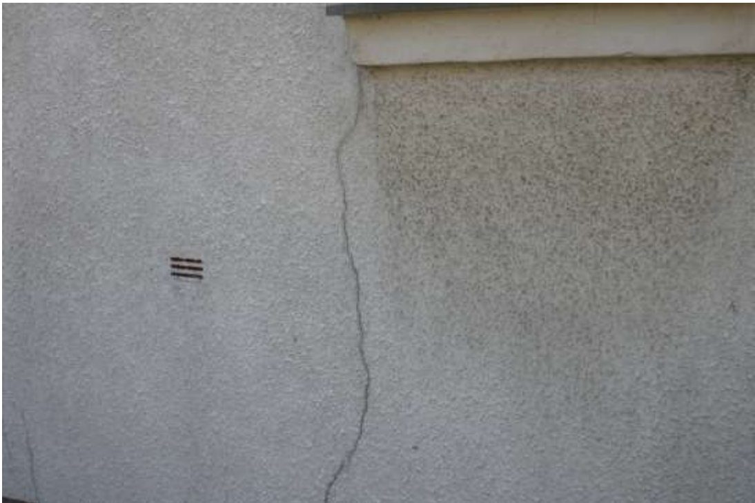
Setzriss an der Nordostseite
