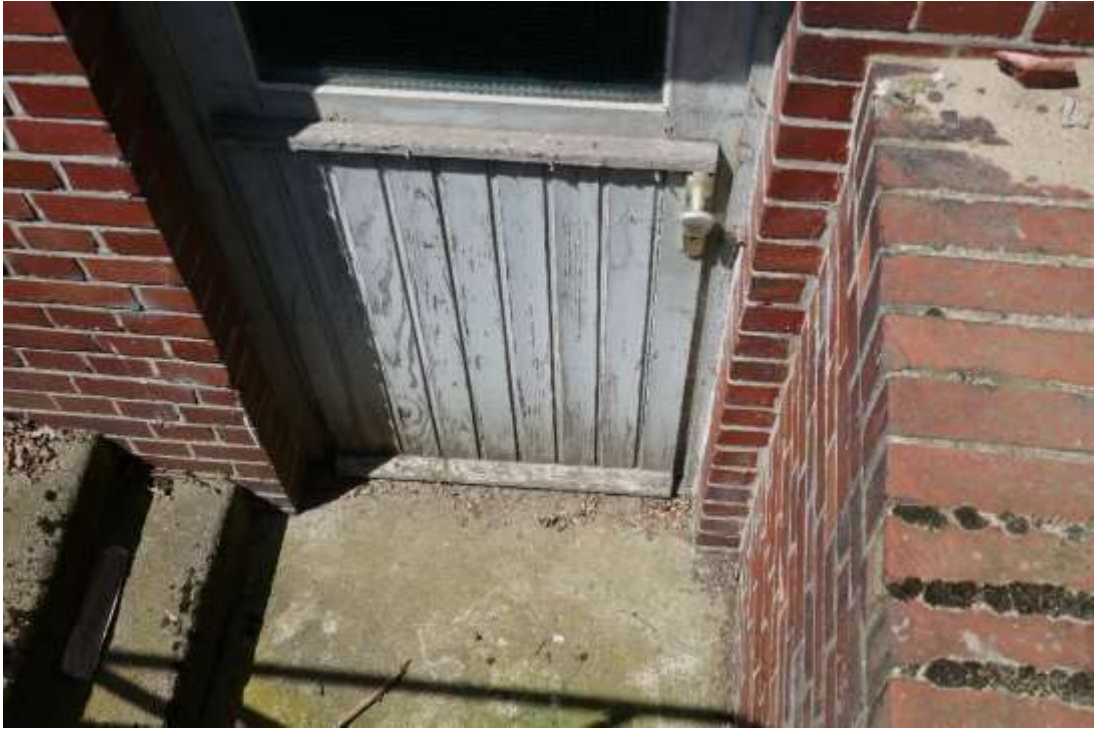
Verwitterter Anstrich der Kelleraußentür
