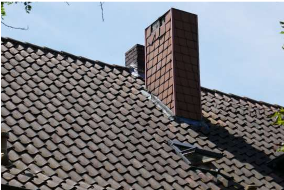
Schäden an der Verkleidung des Schornsteins
