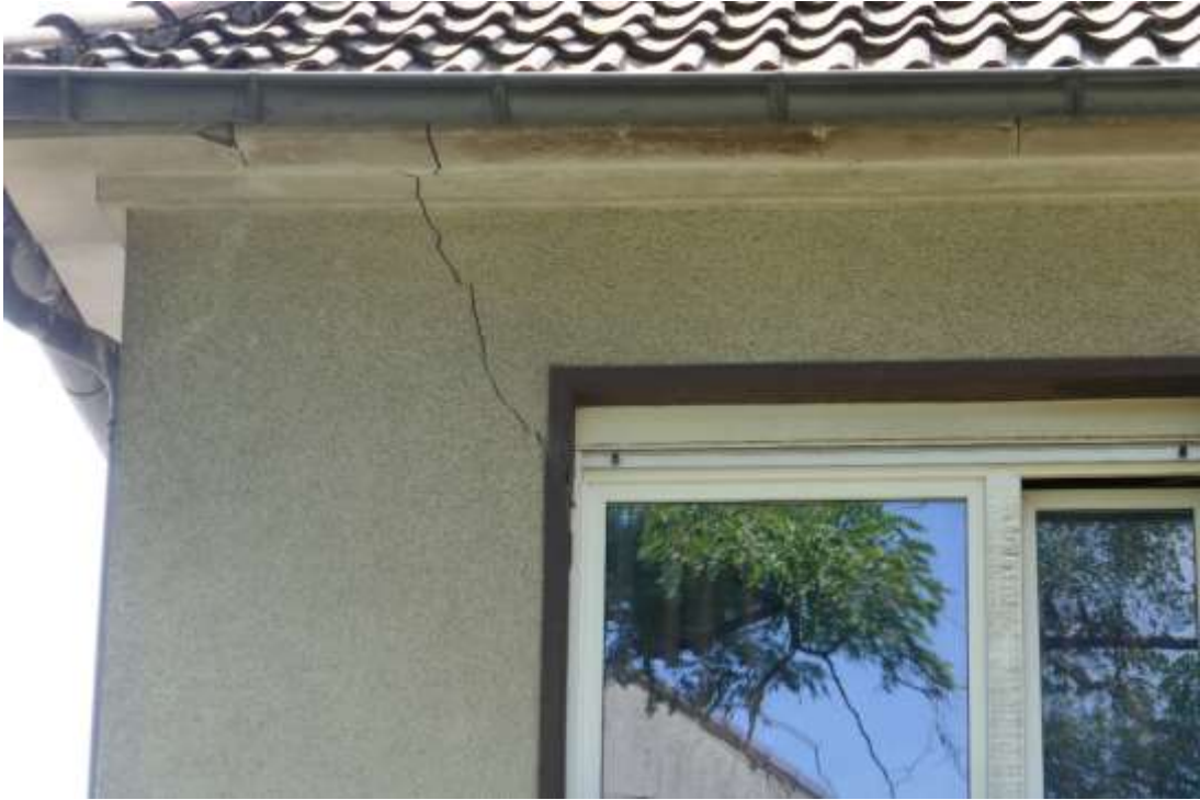
Setzriss an der Nordostseite
