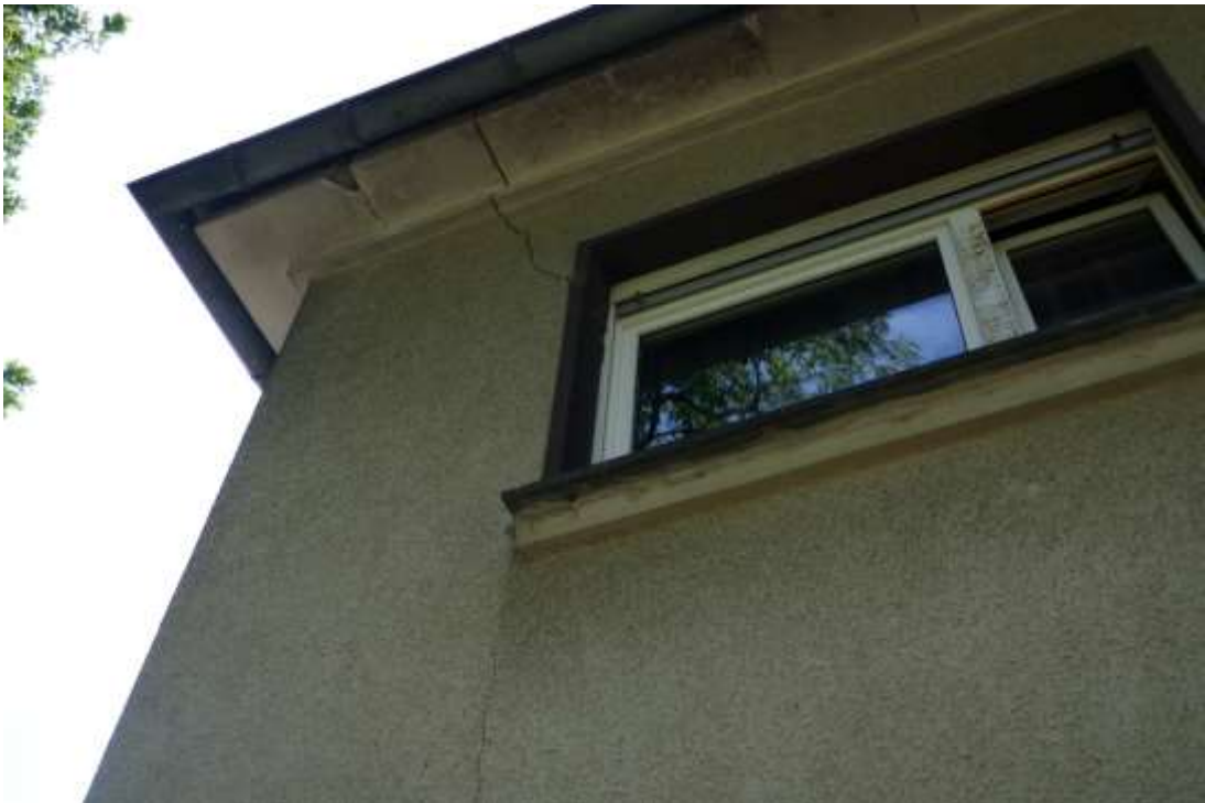
Setzriss und Schäden an den Dachüberständen
