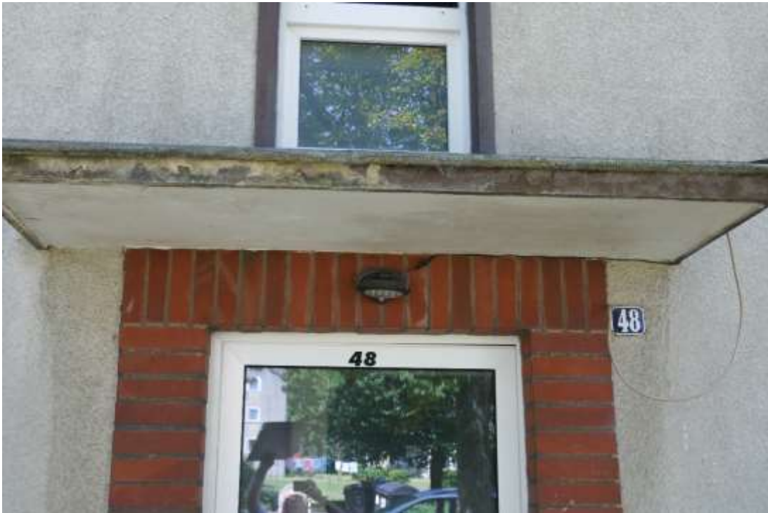
Schäden an der Hauseingangsüberdachung
