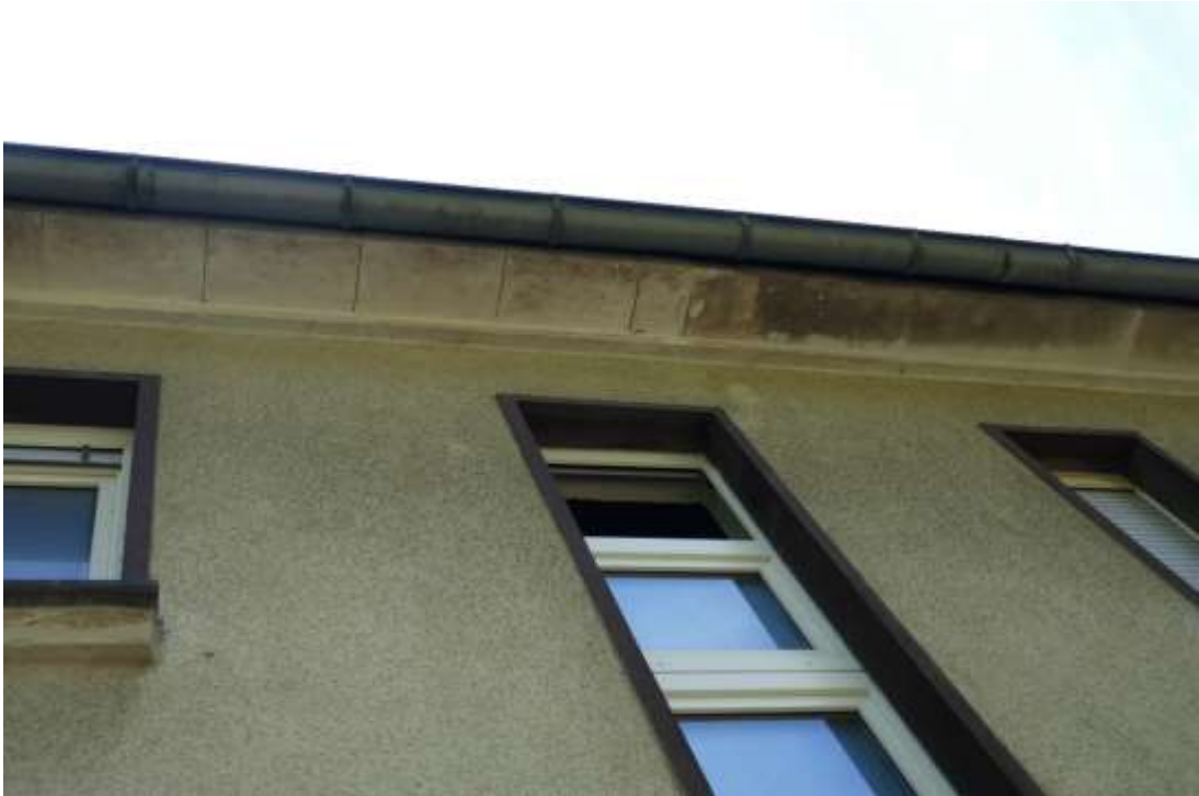
Schäden an den Dachüberständen und Dachrinnen
