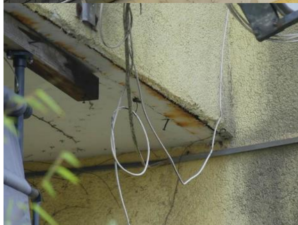
Oxidationsspuren an Stahlträger eines Balkons
