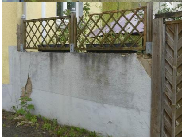
Außenputz der Gartenaußenmauer beschädigt
