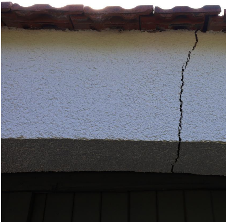
Riss im Putz über dem doppel- fülligen Toren an der Südseite des Gewerbeobjektes
