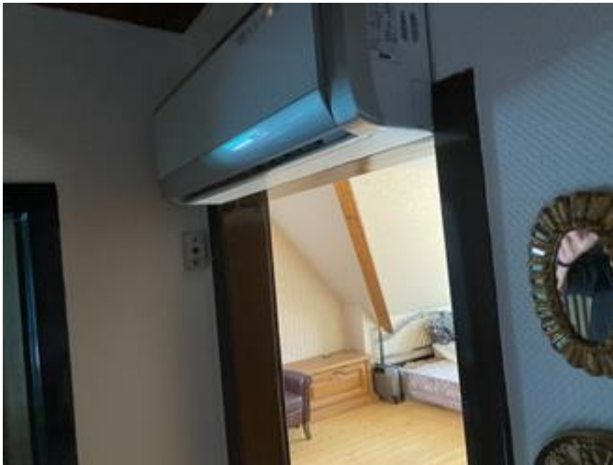
DG, Raum mit Klimaanlage
