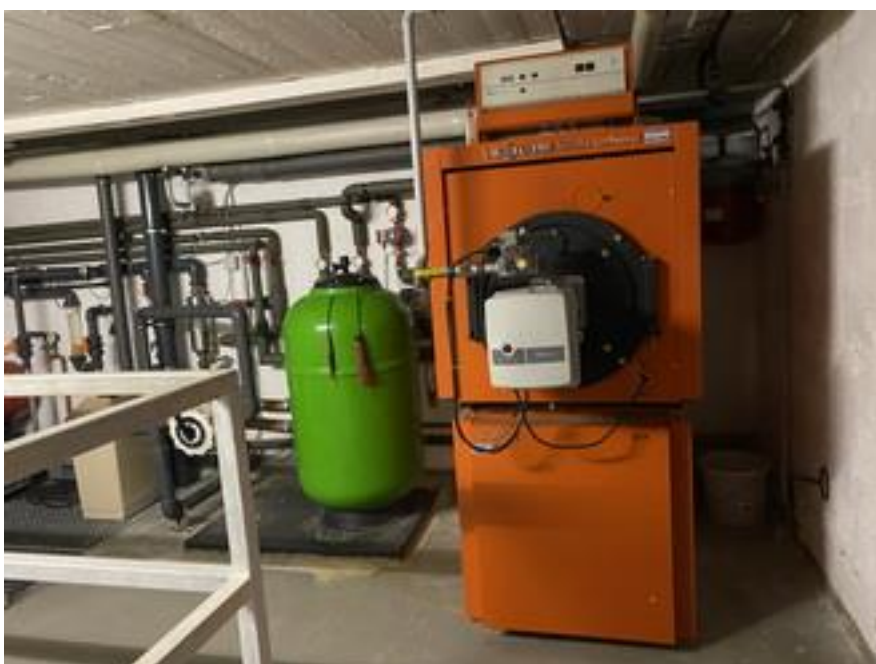
KG, Heizung und Technik für Schwimmbad
