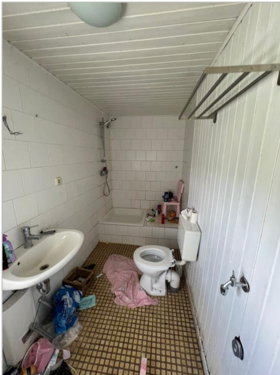
Bad im Anbau EG
