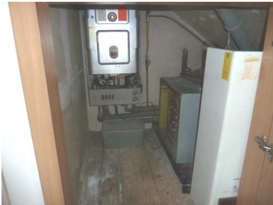
Zentralheizung im Spitzboden
