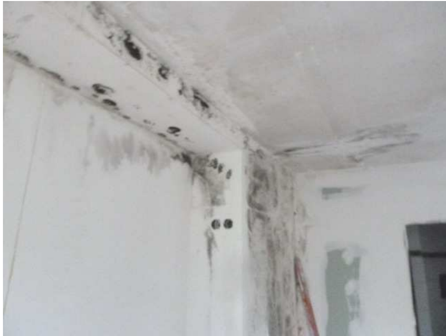
Schimmelbefall an Decke und Wand
