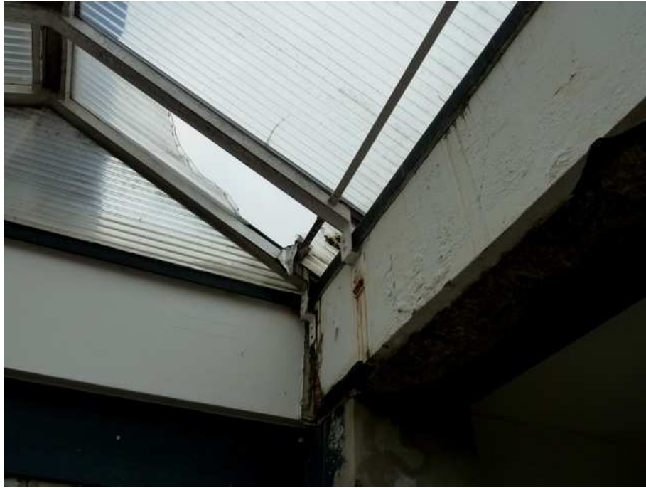
Dachschaden mit Nässe Spuren
