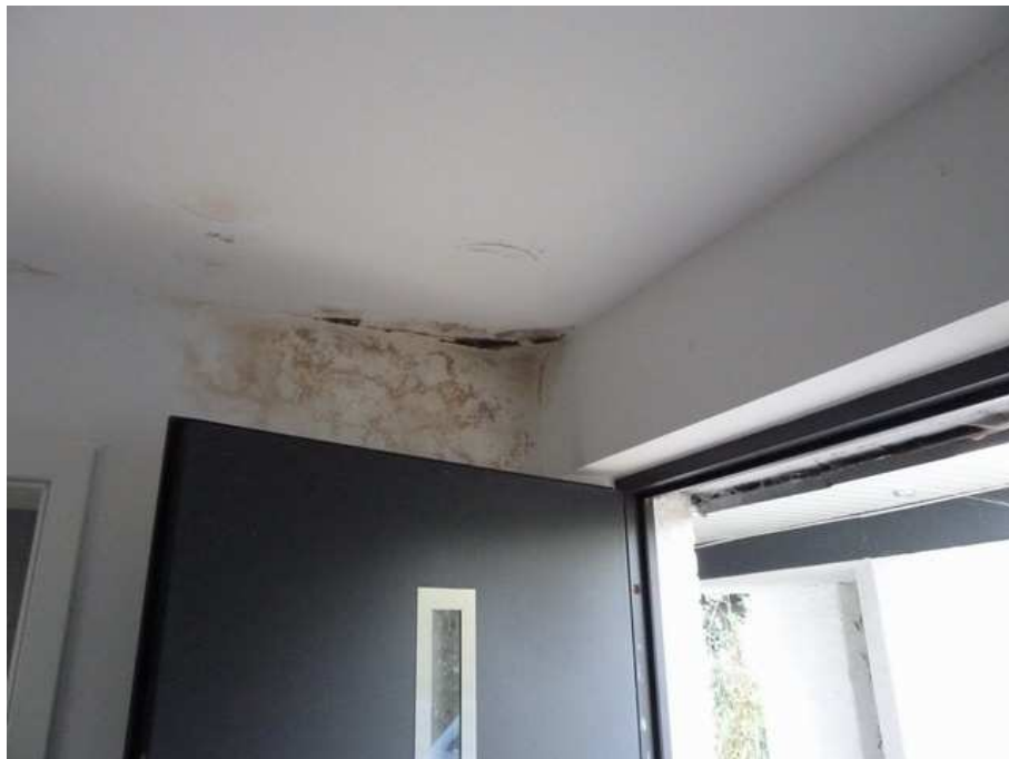
Deckendurchnässung mit Schimmel
