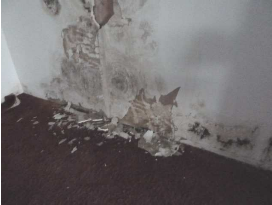
Putzabbrüche und Feuchtigkeitsschäden
