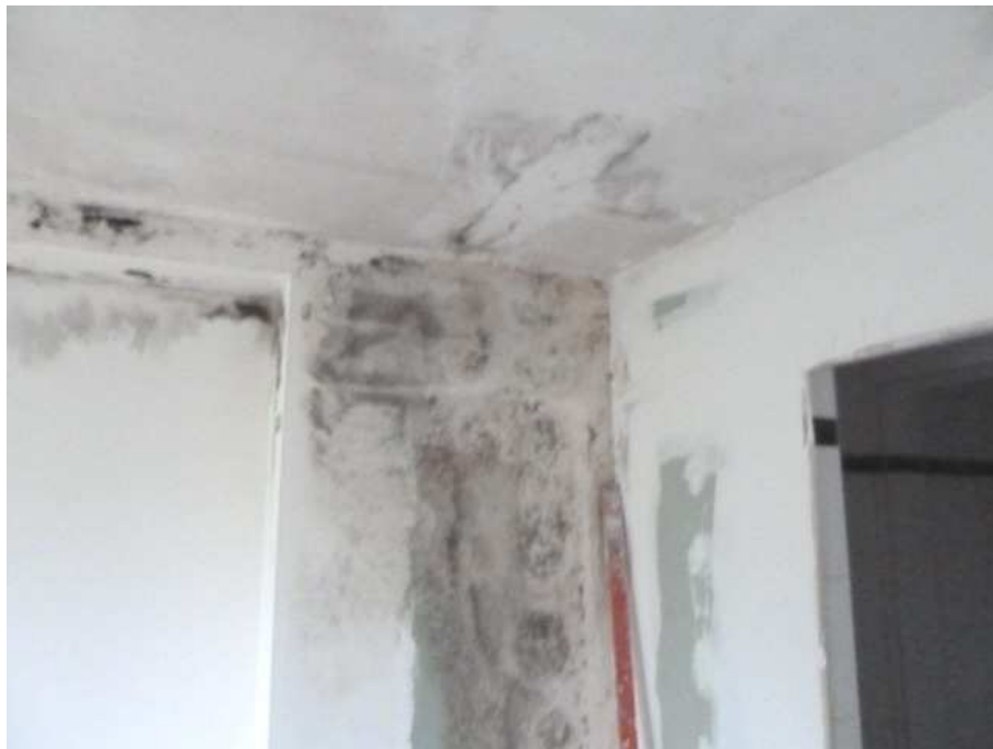
Wand- und Deckendurchnässungen
