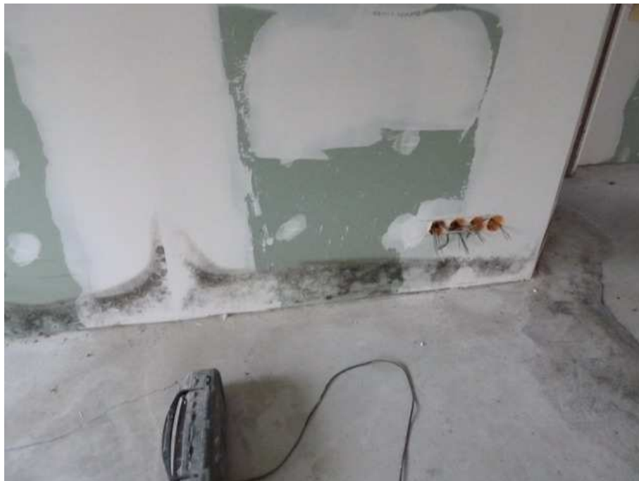
Schimmelbefall mit aufsteigender Nässe
