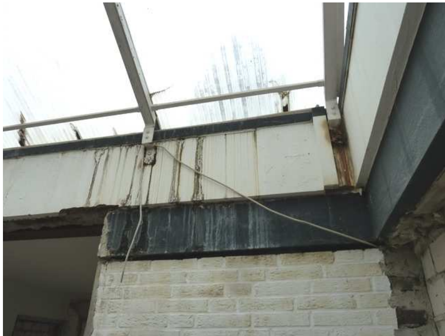
Durchnässungen am Dach
