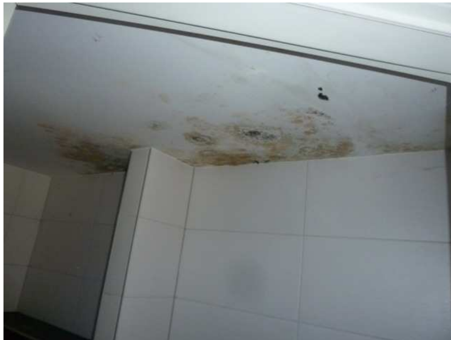
Deckennässe im Bad im Souterrain
