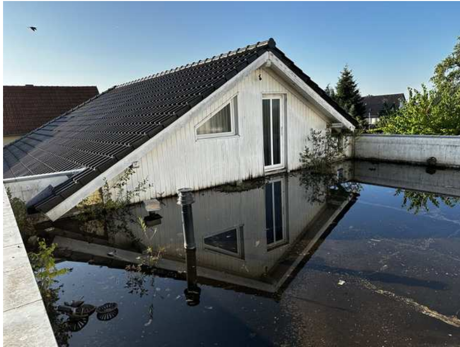
Wasserstau auf dem Flachdach über ehemaliger Praxis
