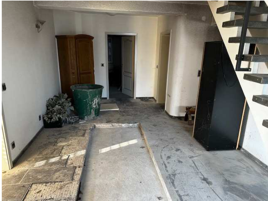
Flur mit Brandschäden im OG / Wohnhaus
