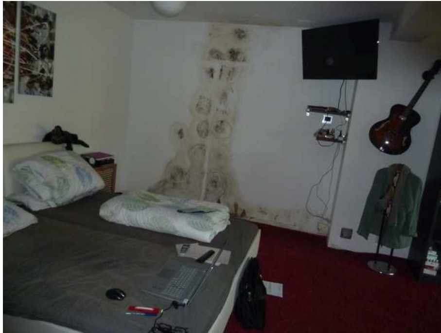
Schlafzimmer in der Erdgeschosswohnung mit Schimmelbefall
