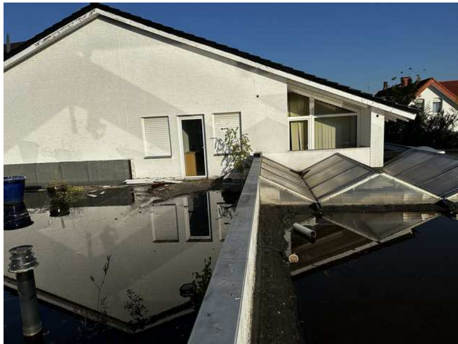
Wasserstau auf dem Flachdach über ehemaliger Praxis
