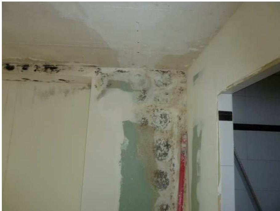
Wand- und Deckennässe im EG ehemalige Praxis
