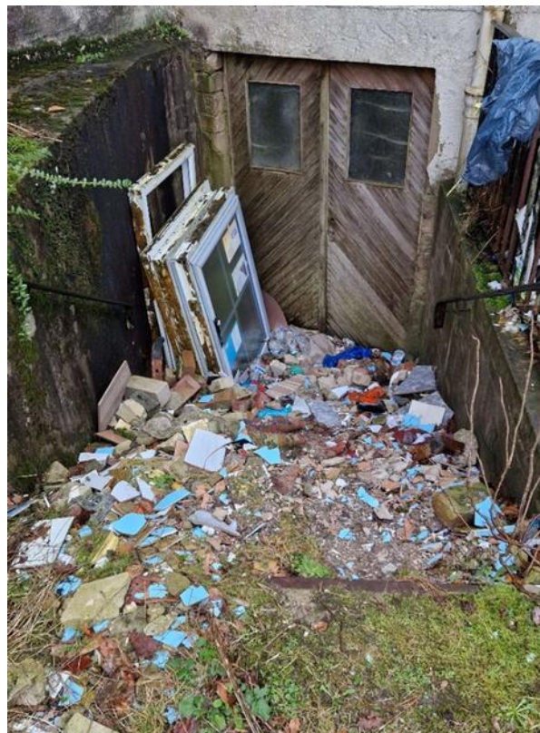
Abbildung 10: Flurstück 106 (Filleberg 3). Abfallablagerungen (i. W. Bauschutt, Fliesen) im Kellerabgang an der Südostseite des Gebäudes. Datum der Aufnahme 14.02.2024.
