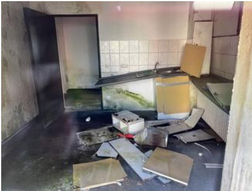
Innenansicht, hinten feuchte Wand (Schimmel)
