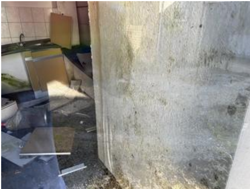
Innenansicht mit feuchter Wand
