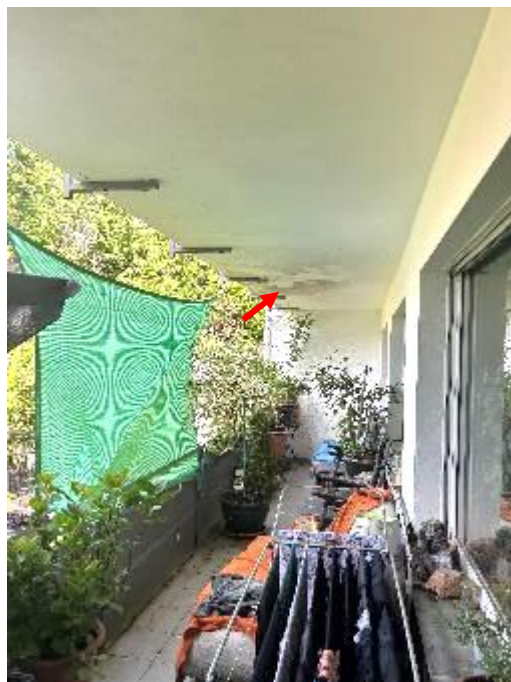
„Flecken“ im Deckenbereich der Loggia
