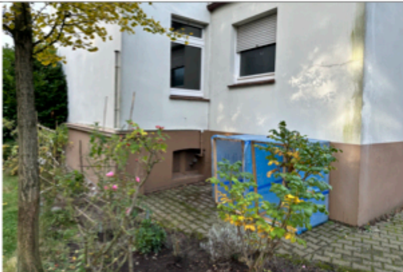
Foto 6 (15.10.2024): Einfüllstutzen Heizöltank (RKB 8)
