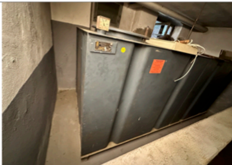
Foto 7 (15.10.2024): Raum mit Heizöltanks
