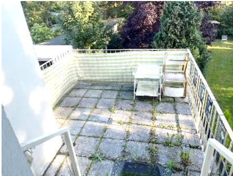
Belag Terrasse hinten schadhaft
