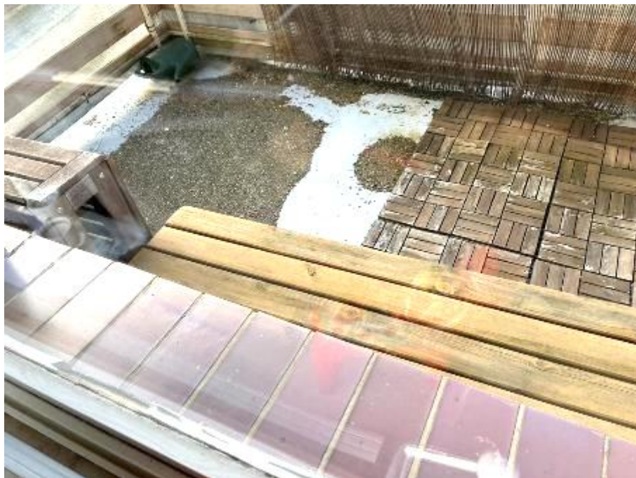
Belag Terrasse vorne schadhaft
