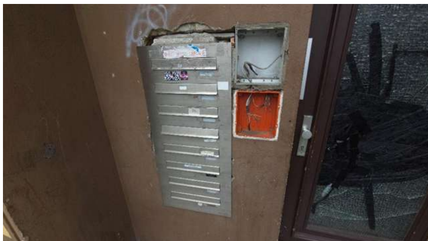
Massive Bauschäden im Hauseingangsbereich.
