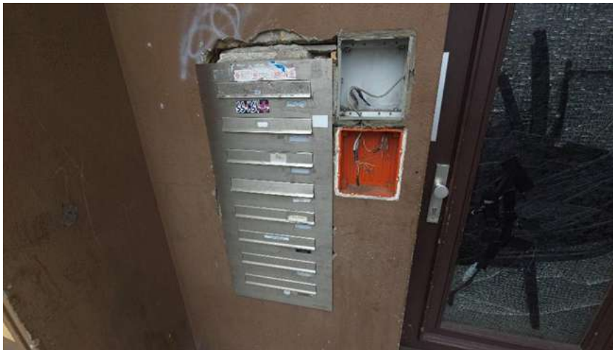
Massive Bauschäden im Hauseingangsbereich.
