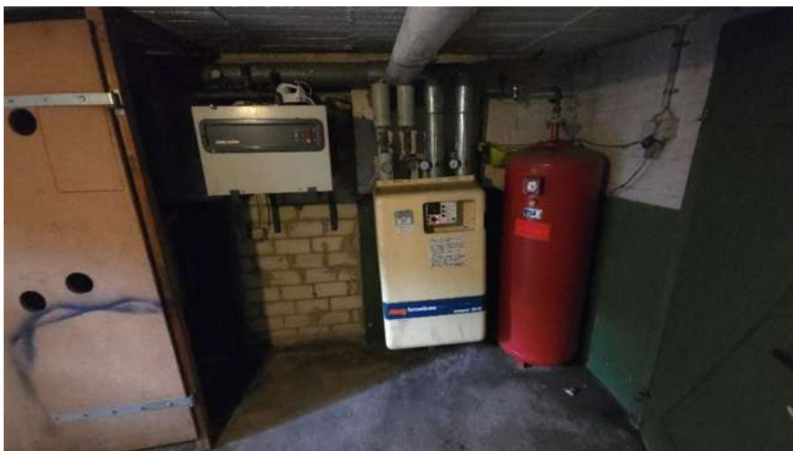
KG; Fernwärmeübergabestation im Wasch- / Trockenkellerraum.
