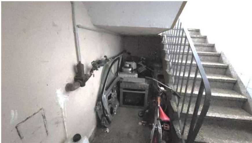
KG; Wasserabschluss; Vermüllung im Kellerflur.
