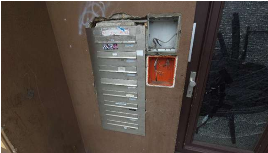
Massive Bauschäden im Hauseingangsbereich.
