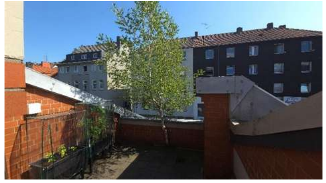
Terrasse im 1.OG mit bauschädigendem Wildwuchs.
