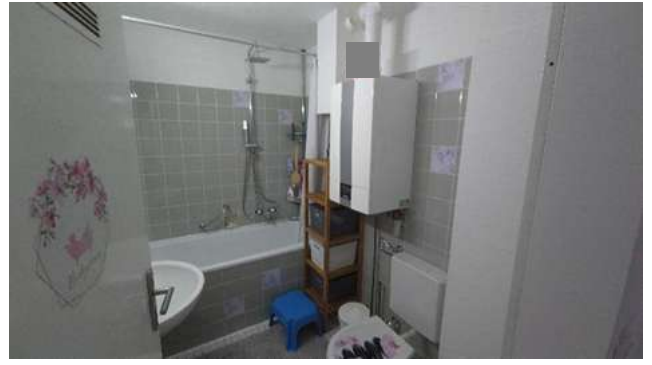
WE 2; Bad/WC mit Gastherme im 2.OG.
