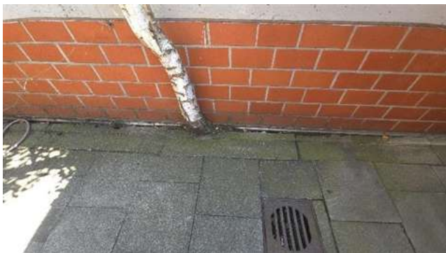
Blick auf die Verwurzelung des Wildwuchses. Der Terrassenbelag weist bereits Schäden auf.
