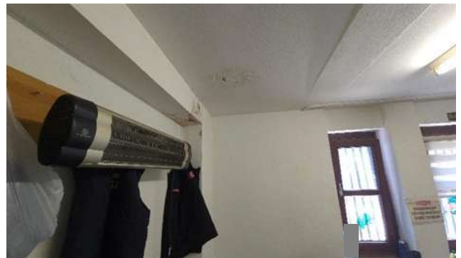
GE; Feuchtigkeitsschaden im Deckenbereich, mutmaßlich verursacht durch den Birkenbaum auf der oberhalb befindlichen Dachterrasse.
