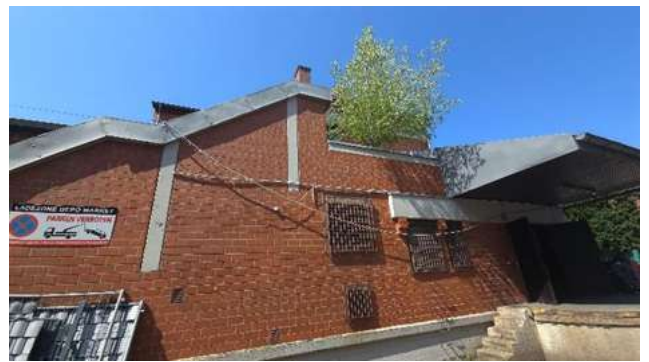
Wildwuchs auf der Dachterrasse, oberhalb des Sozialraumes der Gewerbeeinheit.
