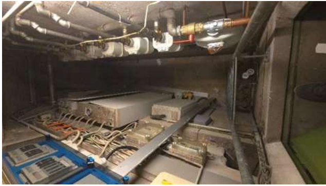
GE; Heizungs- und Hausanschlussraum.
