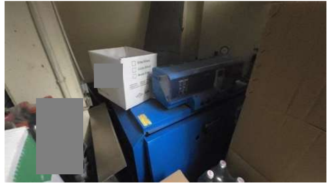
GE; Heizungs- und Hausanschlussraum.
