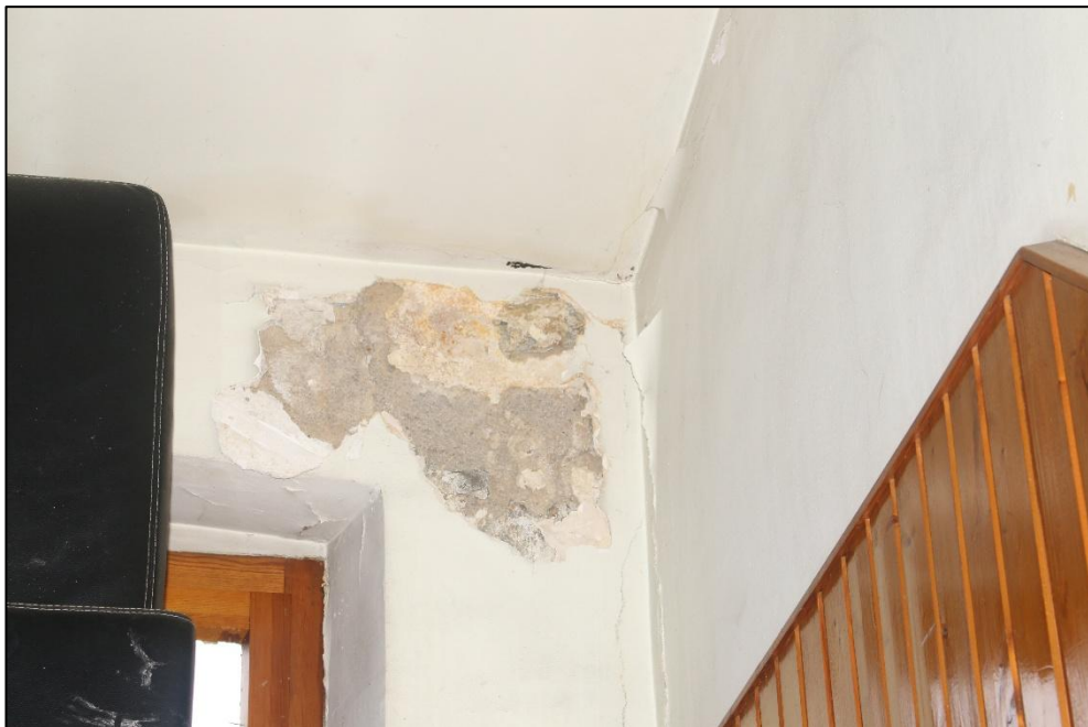
Foto Nr. 28: Gemeinschaftstreppe, DG, Feuchteschäden
