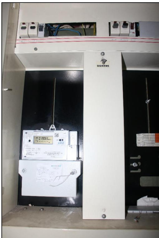
Foto Nr. 22: Gemeinschaftstreppenhaus, 1. OG, Elektroverteilung
