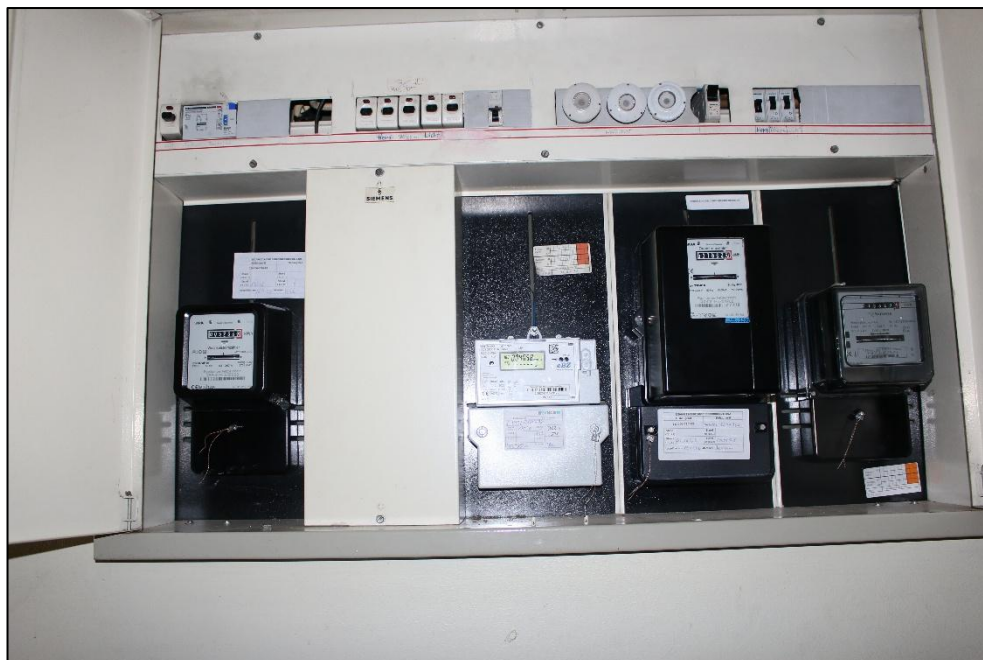
Foto Nr. 19: Gemeinschaftstreppenhaus, EG, Elektrounterverteilung
