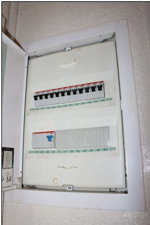
Foto Nr. 63: WE Nr. 5, 2. OG links, Diele / Elektrounterverteilung
