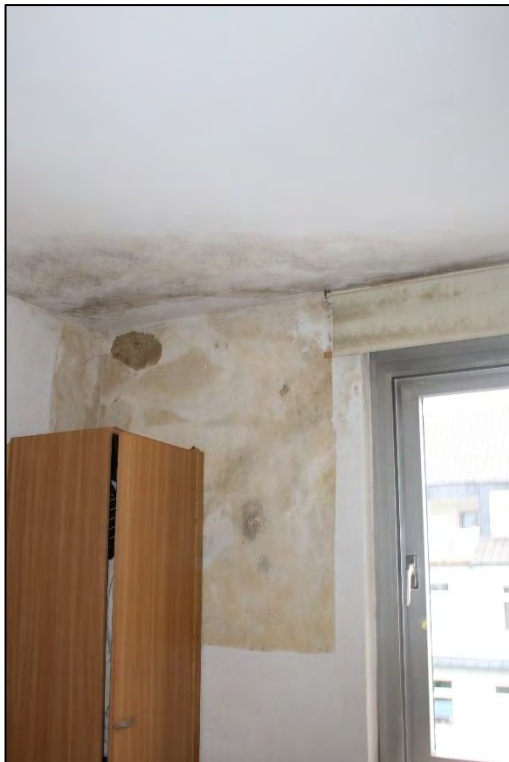
Foto Nr. 85: WE Nr. 7, 3. OG links, Kinderzimmer / Feuchteschäden
