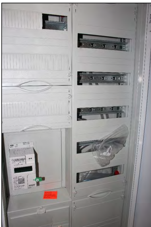
Foto Nr. 16: Kellergeschoss, Elektrounterverteilung
