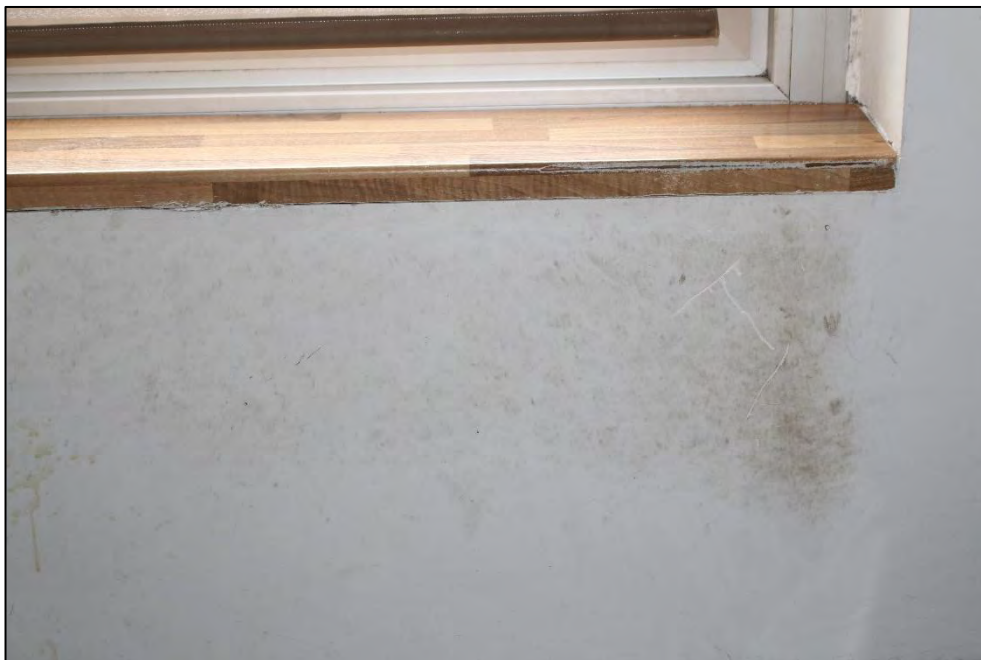
Foto Nr. 29: WE Nr. 1, EG links, Küche / Feuchteschäden
