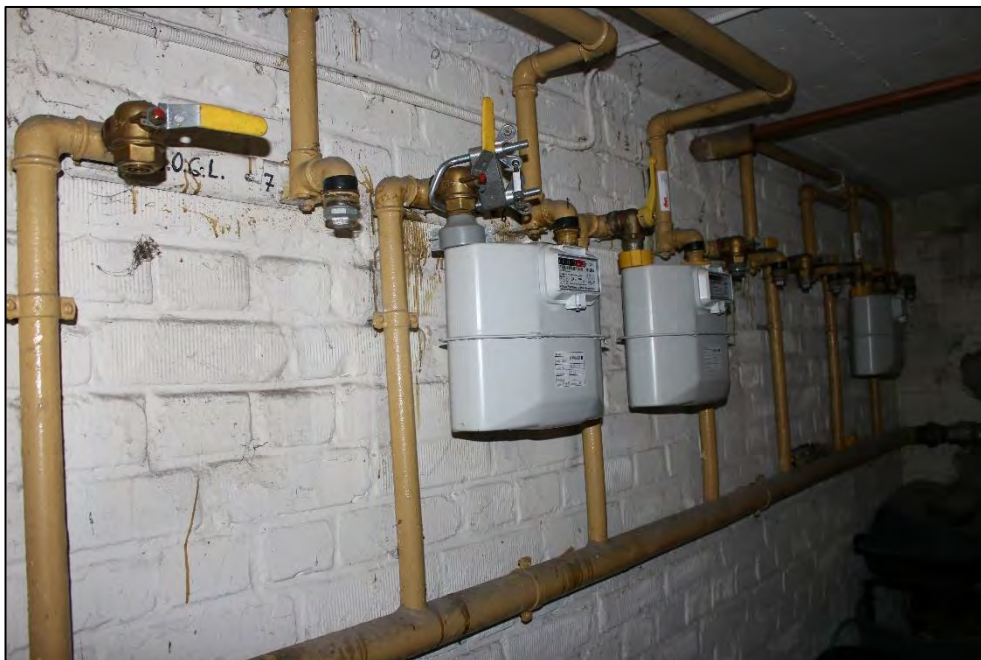
Foto Nr. 15: Kellergeschoss, Hausanschlüsse / Gaszähler
