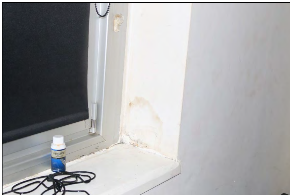
Foto Nr. 24: WE Nr. 1, EG links, Schlafzimmer / Feuchteschäden
