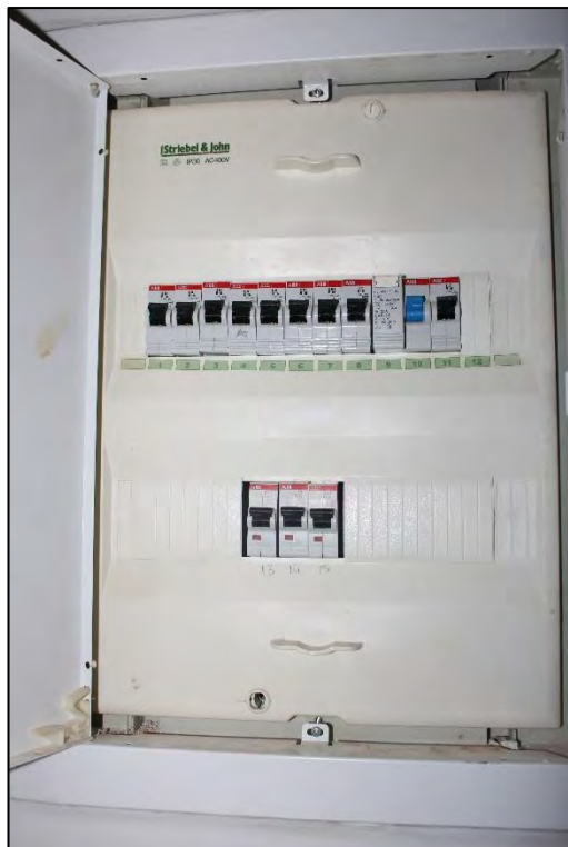
Foto Nr. 23: WE Nr. 1, EG links, Diele / Elektrounterverteilung
