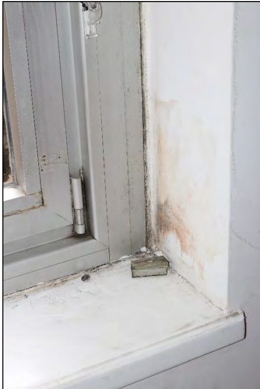
Foto Nr. 31: WE Nr. 1, EG links, Kinderzimmer / Feuchteschäden
