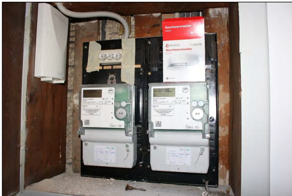
Foto Nr. 21: Gemeinschaftstreppehaus, EG, Elektrounterverteilung
