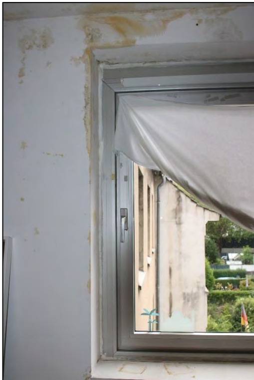
Foto Nr. 99: WE Nr. 8, 3. OG rechts, Kinderzimmer 2 / Feuchteschäden
