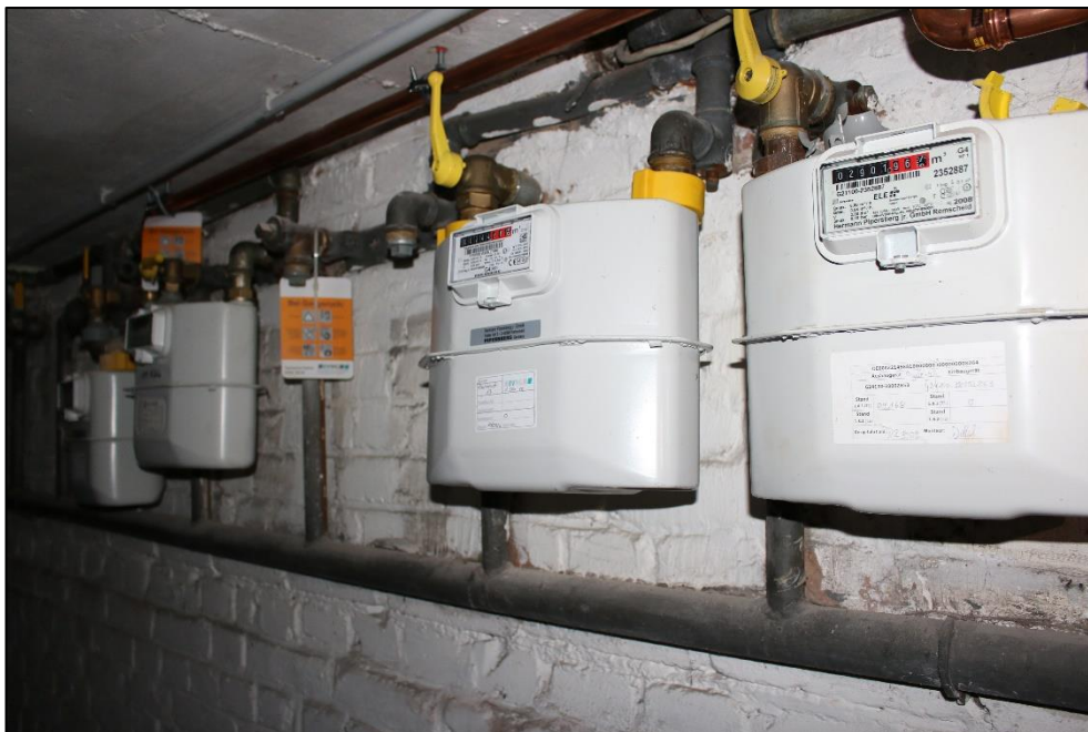
Foto Nr. 26: Kellergeschoss, Flur, Gaszähler
