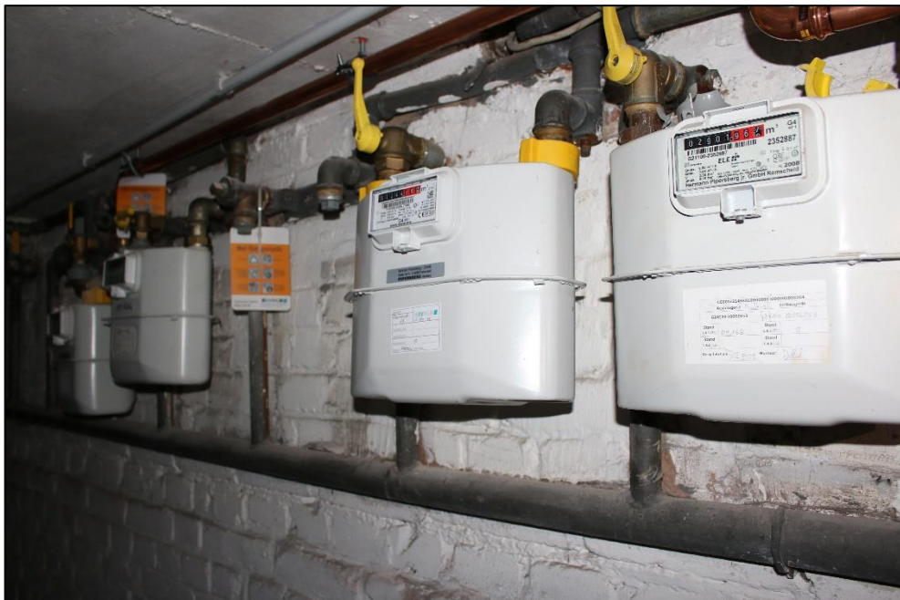
Foto Nr. 26: Kellergeschoss, Flur, Gaszähler
