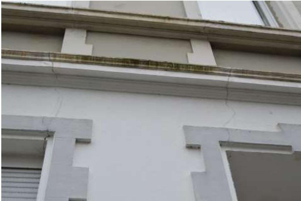
Bild 7: Bsp. Putz- und Fassadenschäden
