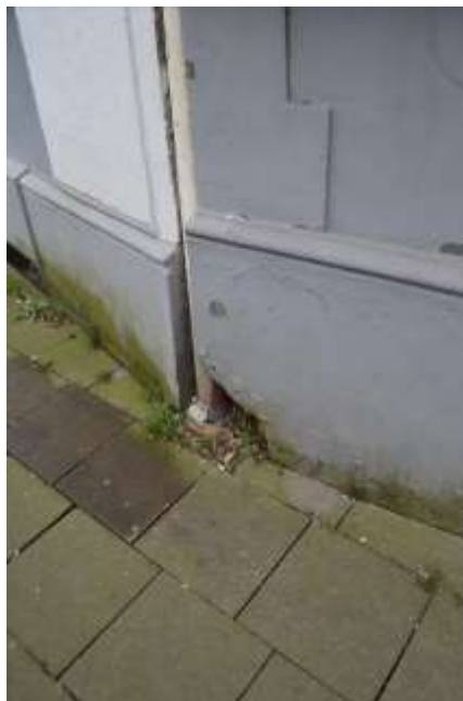
Bild 6: Bsp. Putz- und Fassadenschäden
