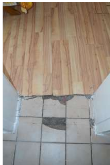
Bild 12: Bsp. schadhafter Bodenbelag
