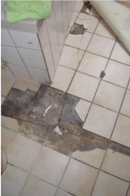
Bild 13: Bsp. Schadhafter Bodenbelag
