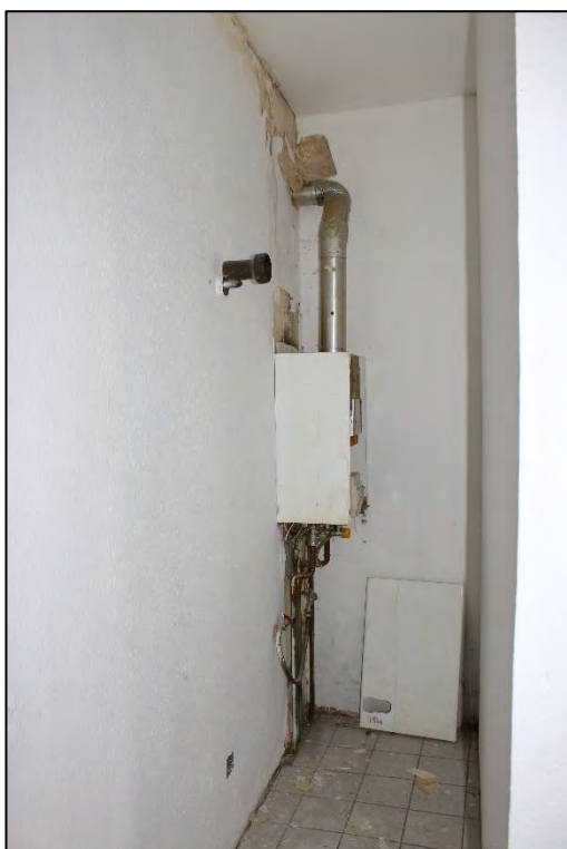
Foto Nr. 72: Anbau, Erdgeschoss, Heizungsanlage
