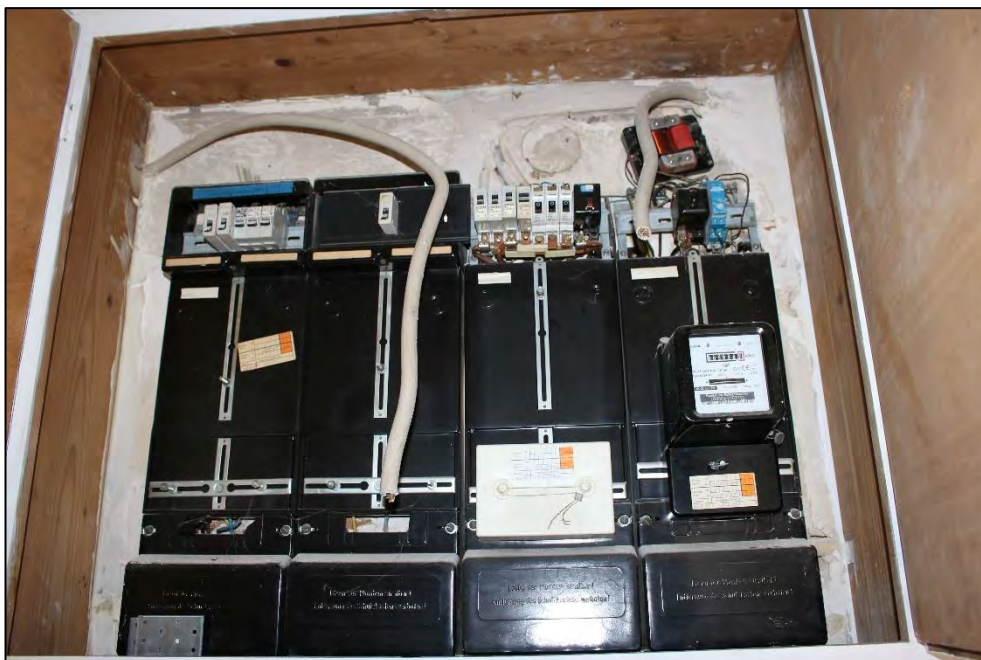
Foto Nr. 52: Gemeinschaftstreppenhaus, Dachgeschoss, Elektrounterverteilung
