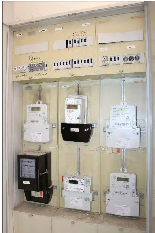
Foto Nr. 87: Gemeinschaftstreppe, Erdgeschoss, Elektrounterverteilung
