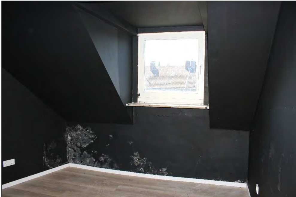
Foto Nr. 57: Dachgeschoss, WE Nr. 5, Raum 2 / Feuchteschäden
