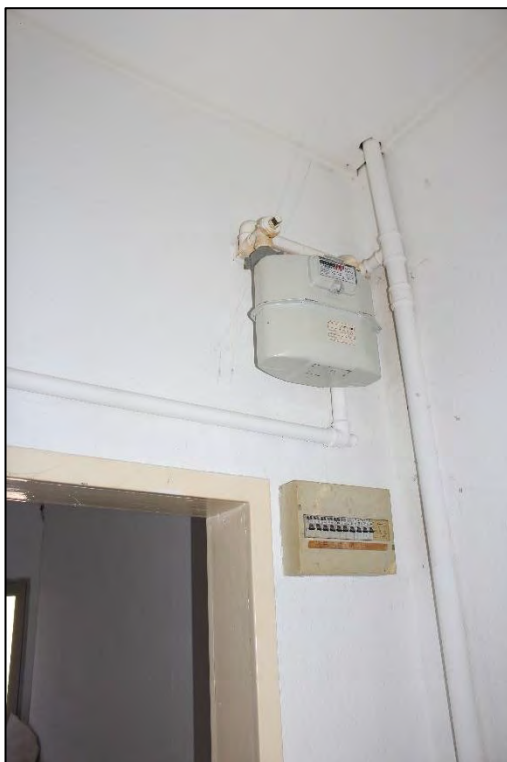
Foto Nr. 76: Anbau, Erdgeschoss, Flur, Gaszähler
