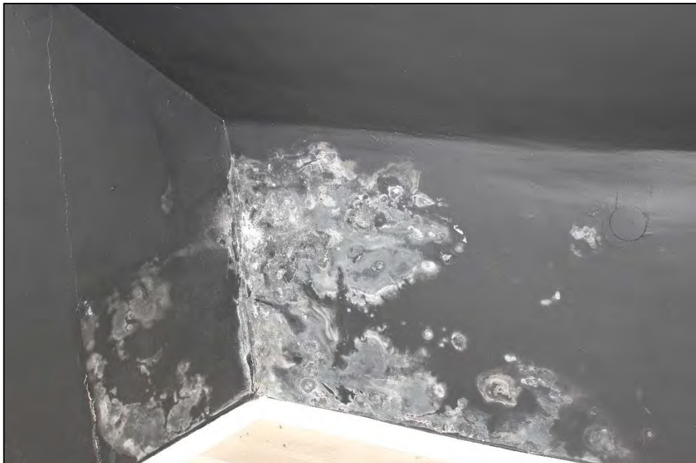
Foto Nr. 58: Dachgeschoss, WE Nr. 5, Raum 2 / Feuchteschäden
