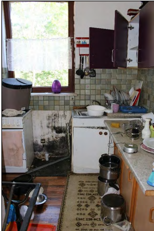
Foto Nr. 99: WE Nr. 2, Erdgeschoss rechts, Küche / Feuchteschäden
