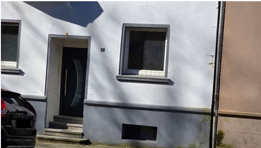
Hauseingangsbereich und Verschmutzung der Fassade im Sockelbereich.
