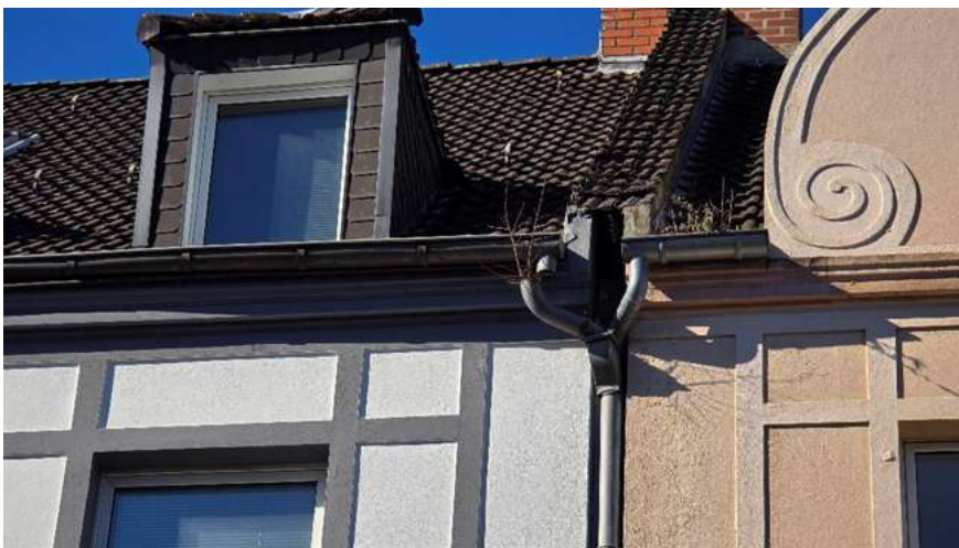
Vom Regenfallrohr abgelöste Dachrinne.
