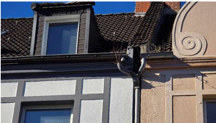
Vom Regenfallrohr abgelöste Dachrinne.
