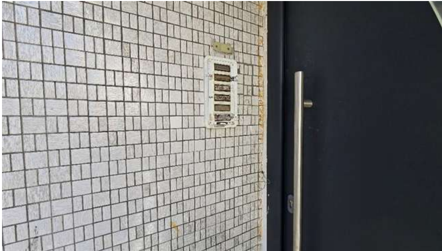
Verschmutzung im Hauseingangsbereich mit mutmaßlich defektem Klingelschild und frei liegenden Drähten.
