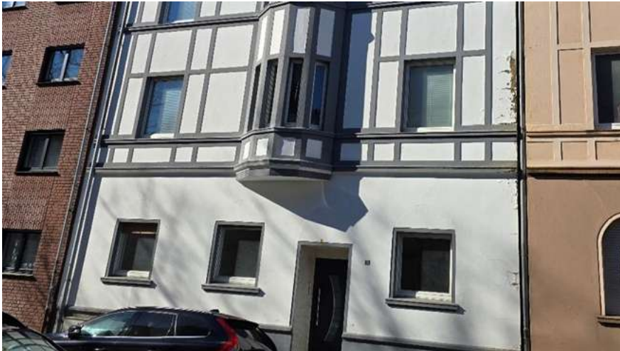
Ablösender Fassadenputz und -Anstrich an der rechten Seite.
