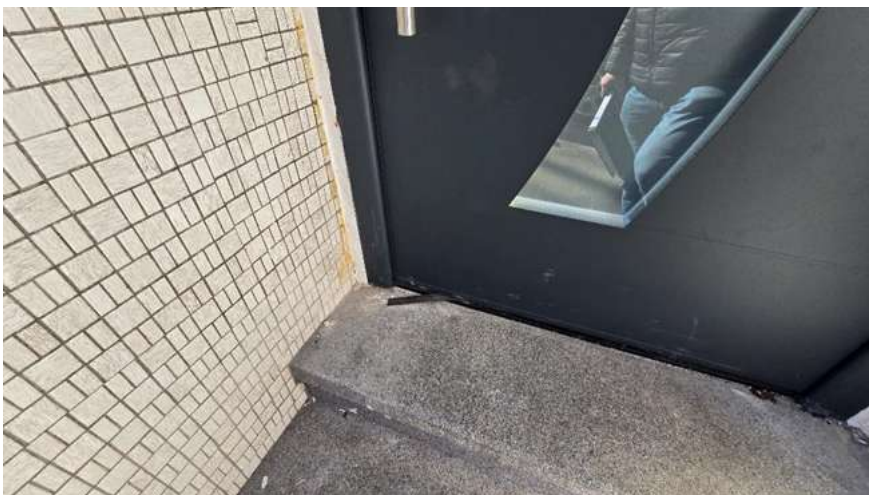
Beschädigung der Hauseingangstür.
