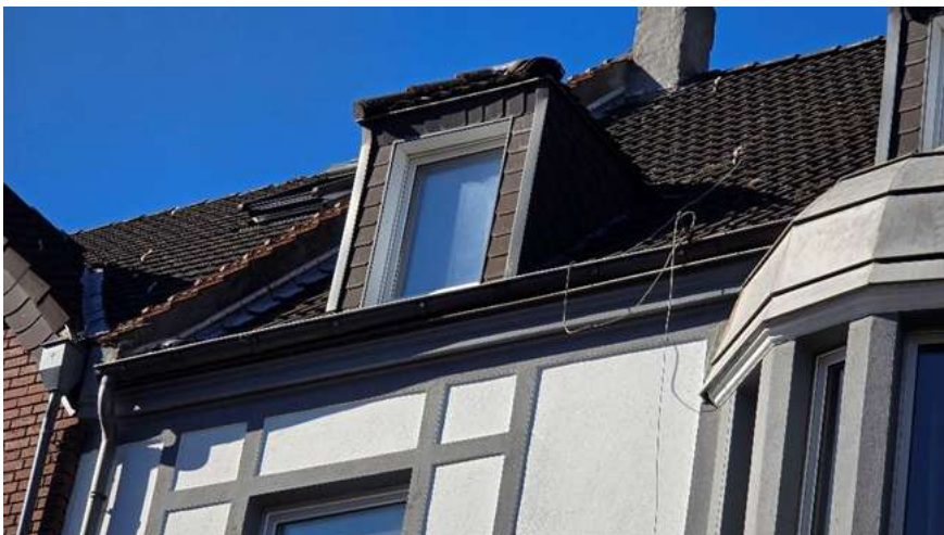
Unbefestigte Kabel vor der Fassade.
