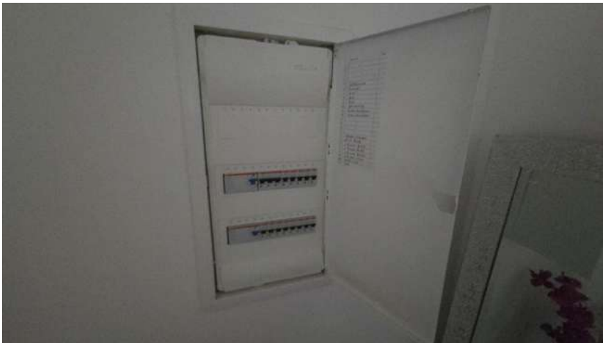
WE 3; Elektrounterverteilung mit Sicherungsautomaten.
