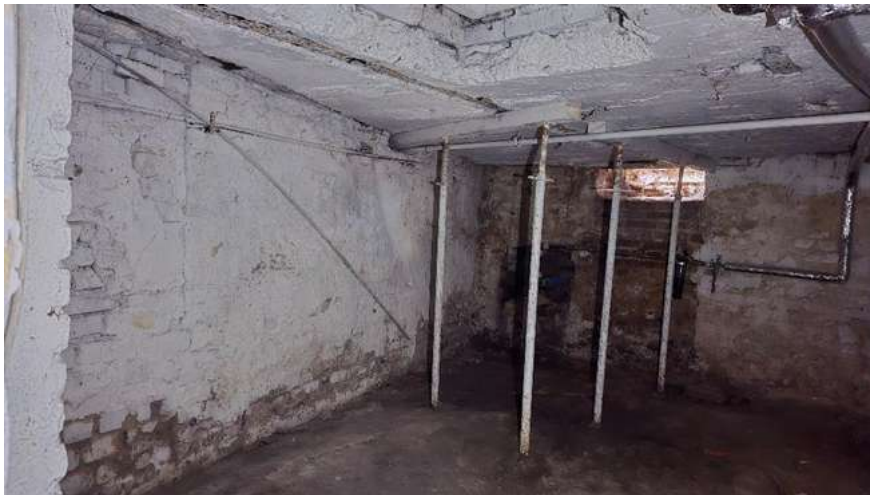
Kellerraum mit Deckenstützen und Feuchtigkeitsschäden.
