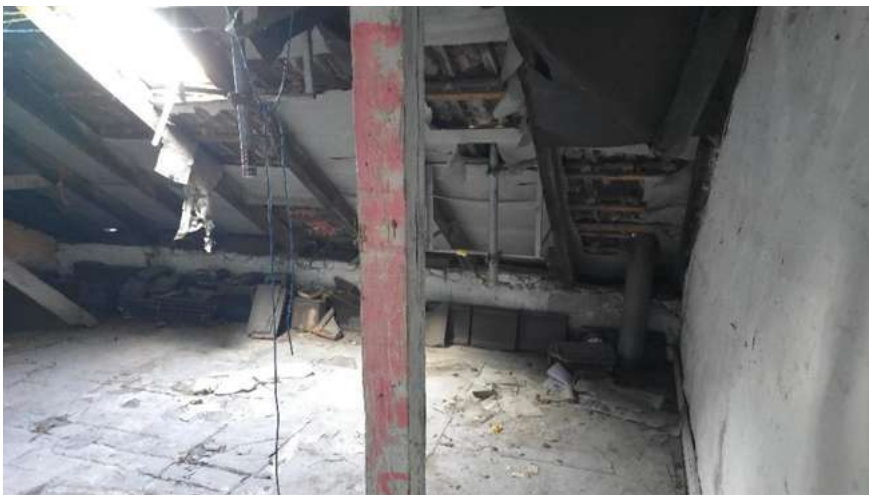
Beschädigung an der Dachabdichtung.
