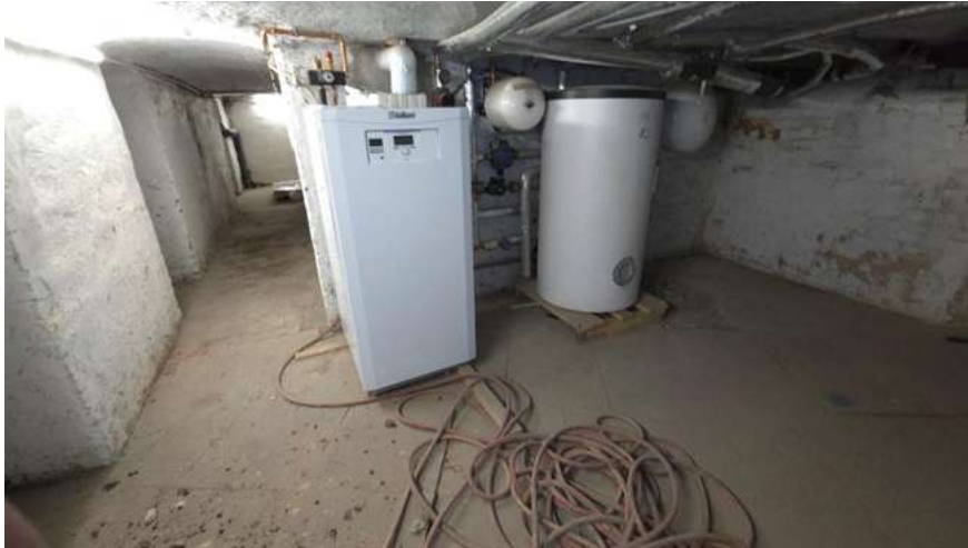
Zentraler Kellerflur mit Heizungsanlage und Warmwasserspeicher.
