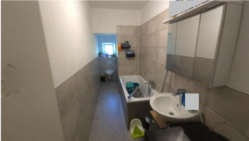
WE 3; Bad/WC mit beschädigter Tür.
