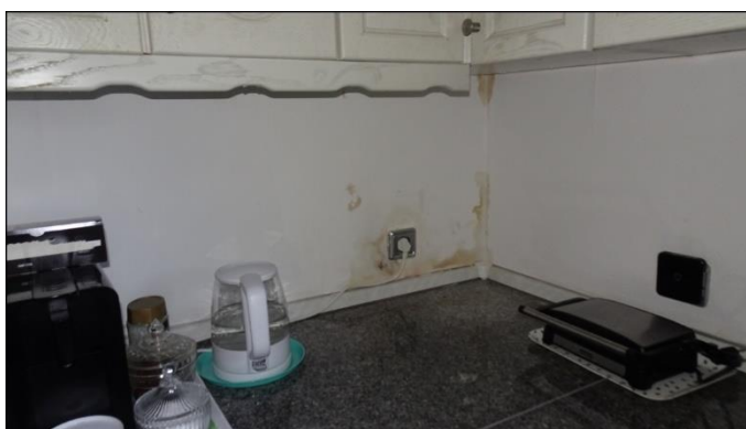
8) Sondereigentum Nr. 14/ Feuchtigkeit im Bereich der Steckdose
