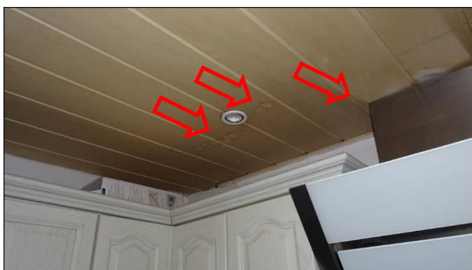
9) Sondereigentum Nr. 14/ Feuchtschäden Decke
