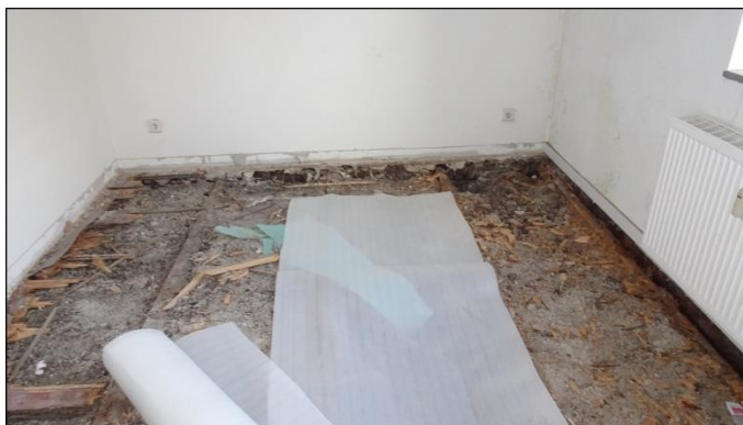
12) durchgefallene Balkenlage in der darüberliegenden Wohnung
