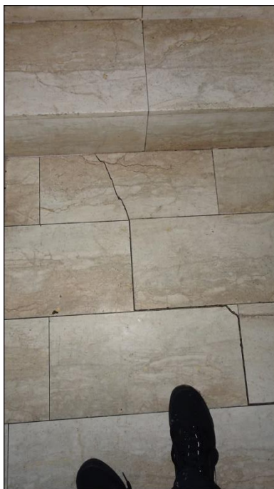
10) Sondereigentum Nr. 14/ Risse im Fußbodenbelag
